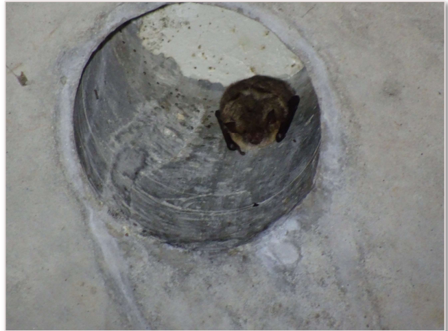
MURIN A OREILLES ECHANCREES DANS UN TROU DE RESERVATION EN INTRADOS DU VIADUC EN SENS1 VERS LA CULEE C1 (AOÛT 2022)
