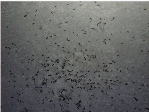
GUANO AU SOL DANS LE CAISSON CENTRAL EN SENS 2
