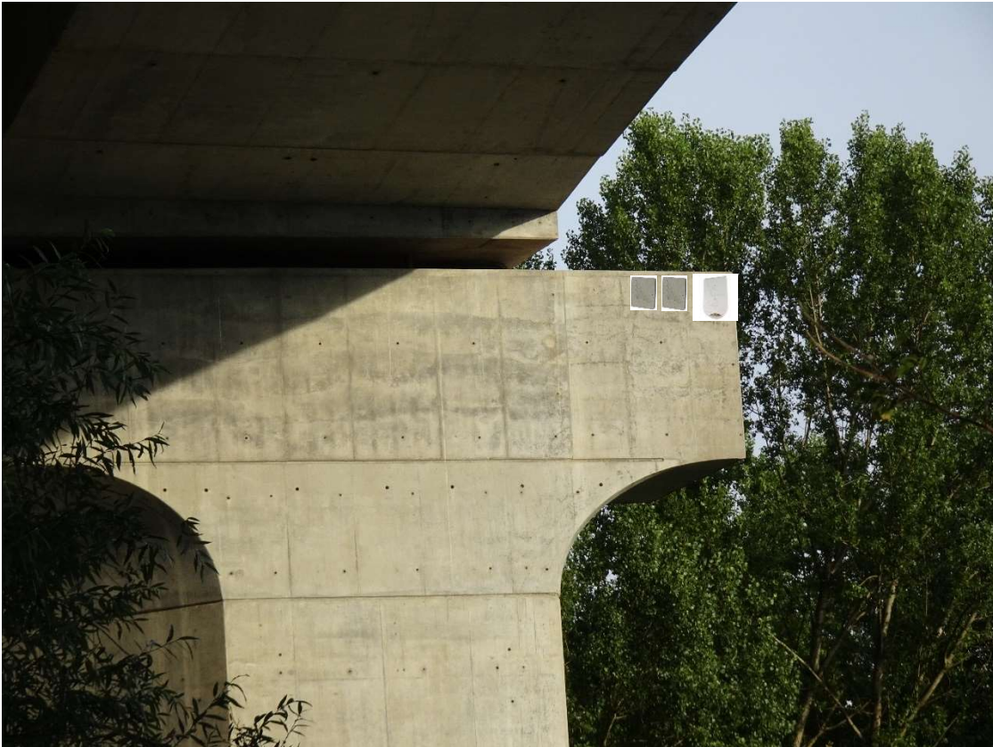
Figure 53. Illustration d'un module installer sur un chevêtre (ici P4 en sens 2, côte NO)
