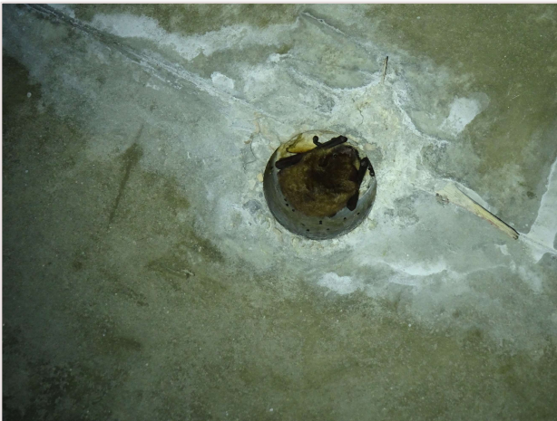
MURIN SP (PROBABLE DAUBENTON) DANS UN TROU DE RESERVATION DU CAISSON CENTRAL EN SENS 2 (AOÛT 2022)
