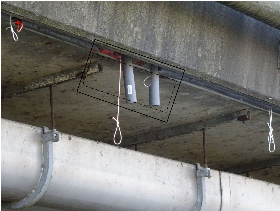
Figure 47. Illustration d'un dispositif antiretour avec mise en place de manchons à la verticale de part et d'autre de l'espace corniche tablier (où se trouve les chauves-souris) pour empêcher les mouvements latéraux des chiroptères (sur la photo ces derniers dépassent, mais doivent en réalité être coupés à fleur de la corniche), Ribatto 2022, A40
