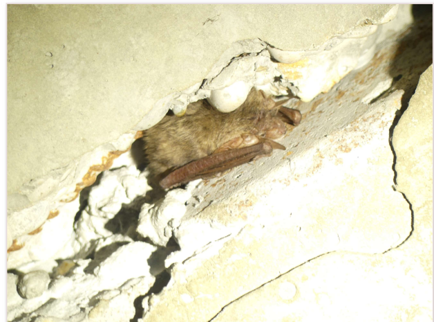
OREILLARD ROUX DANS UN DEFAUT DE BETON DU CAISSON CENTRAL EN SENS 2 (SEPTEMBRE 2022)
