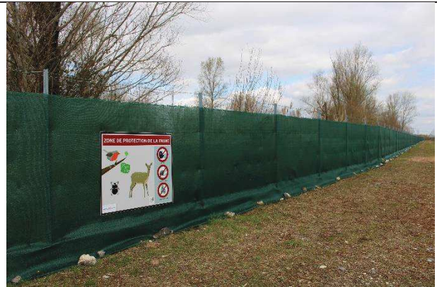
Exemple de protection renforcée et panneau d'information informatif Centrale nucléaire du Blayais (33) – Travaux de protection périphérique contre les inondations
