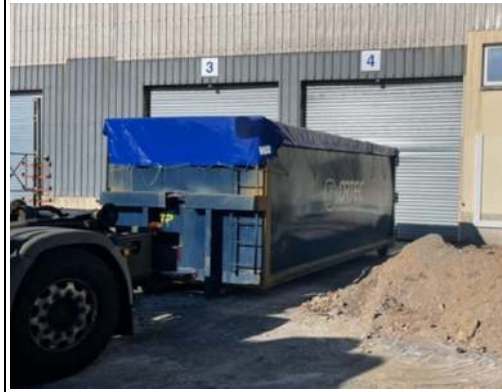
Livraison de l'unité de traitement des eaux
