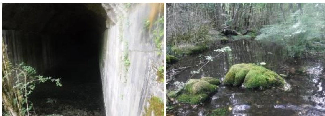
Figure 166 : Zone en eau sous le tunnel de Saut-Mortier (à gauche) et étendue d'eau forestière sur la zone 2 (à droite)
