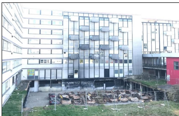
Dalle effondrée à la suite de l'incendie de 2020
