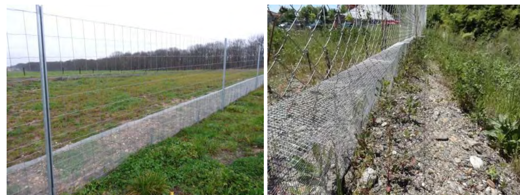
Photographie 48 : Exemple de clôtures à mailles fines 5 mm x 5 mm
