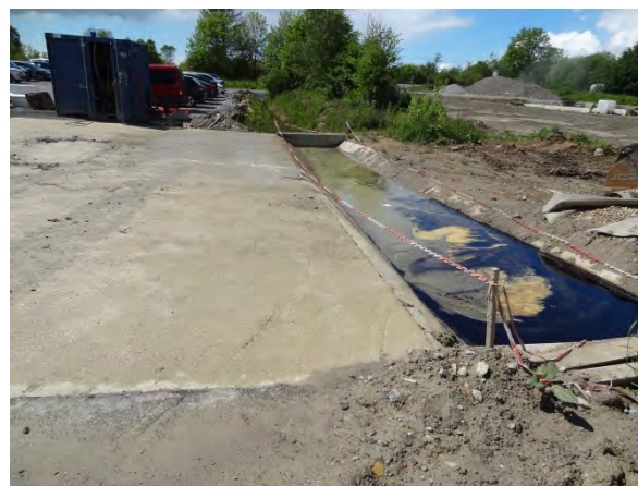
Photographie 46 : Exemple de bassin de stockage de produits polluants, d'aire de lavage de goulotte de toupies et d'aire de lavage d'engins équipée en sortie d'un débourbeur-déshuileur (© Egis / D. Ferreira)
