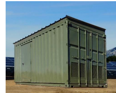
Exemple de local de maintenance
