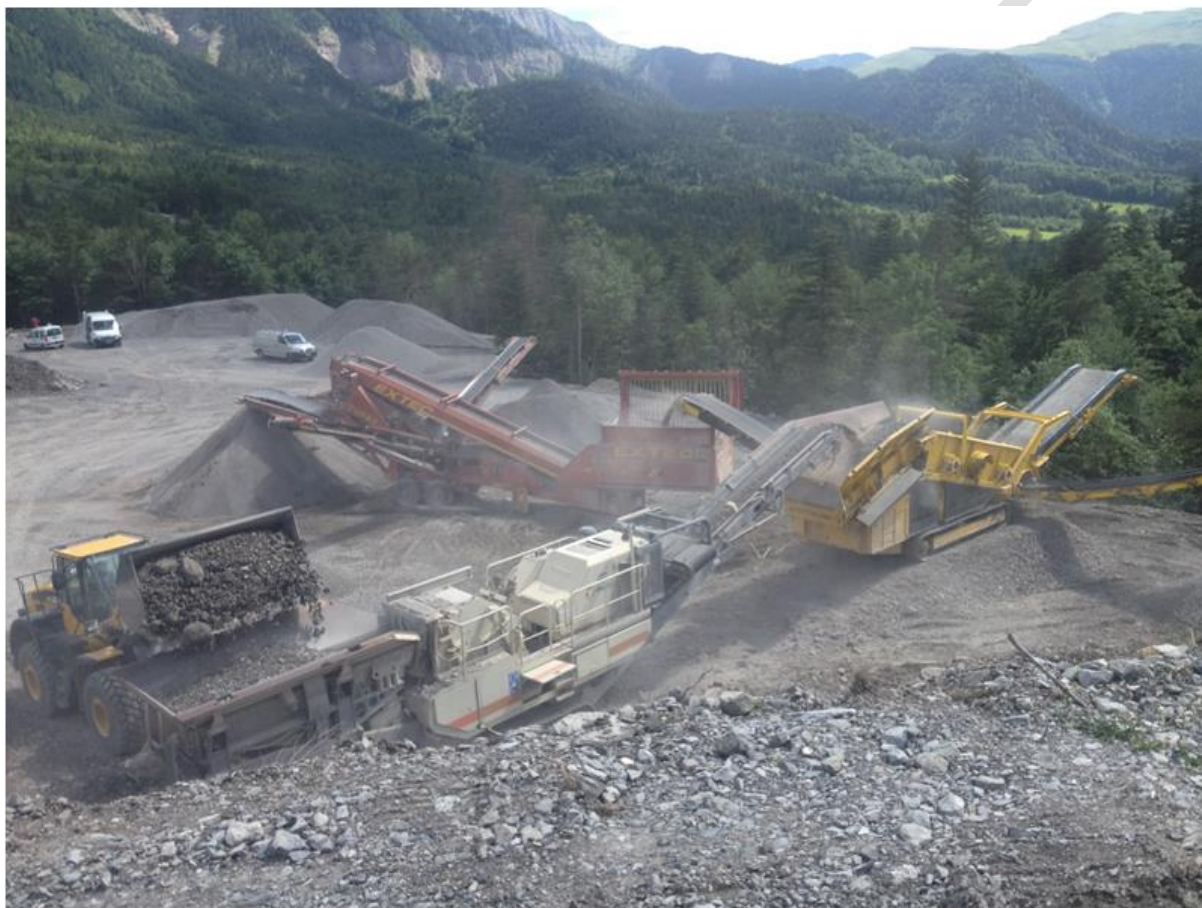
Figure 24 : Carrière de concassage de la plage de dépôt de l'Ebron (Source : Trièves Travaux)
