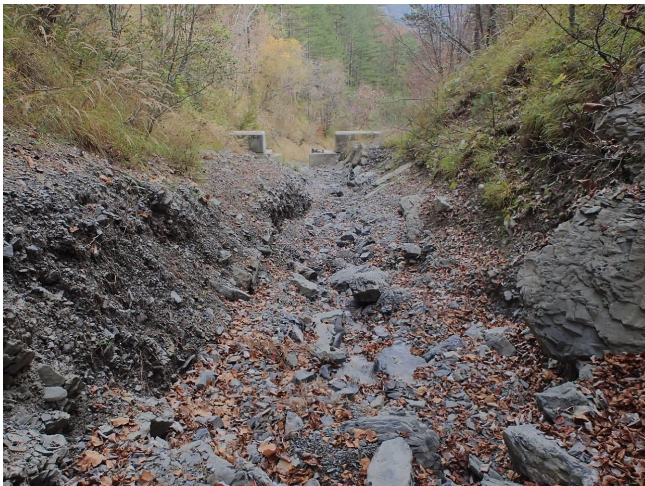
Photo 2 : Lit du Rattier avec fortes respirations en amont du barrage.
