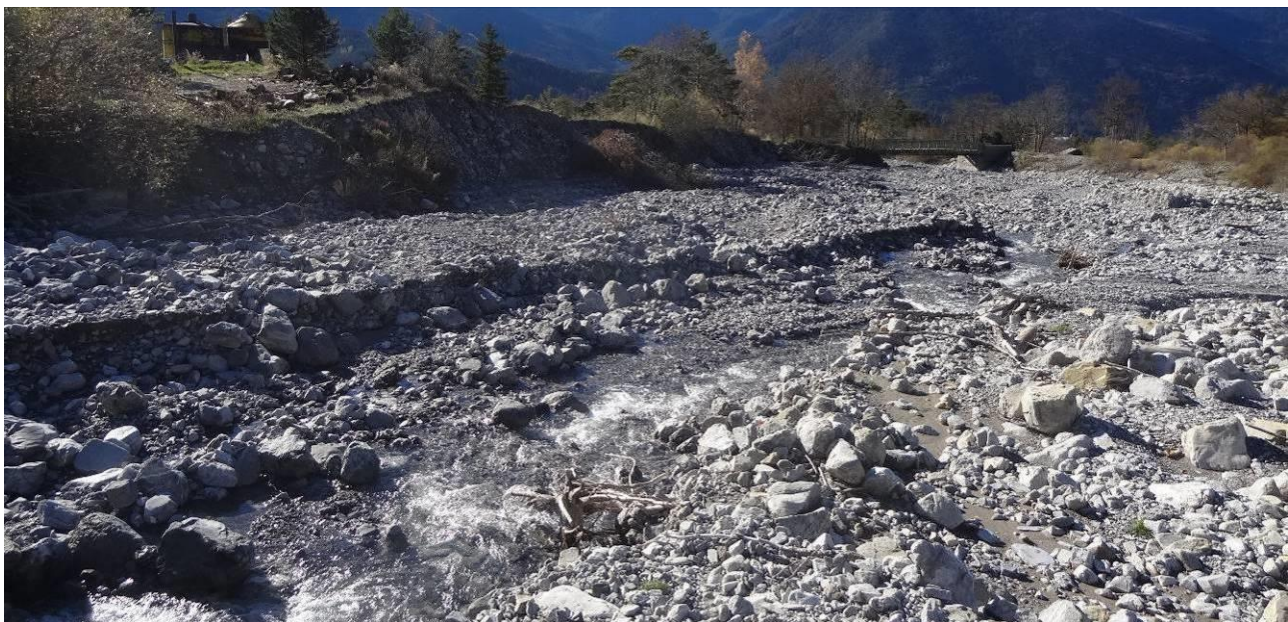
Photo 81 : Berge rive gauche vulnérable et pont du Serre.
