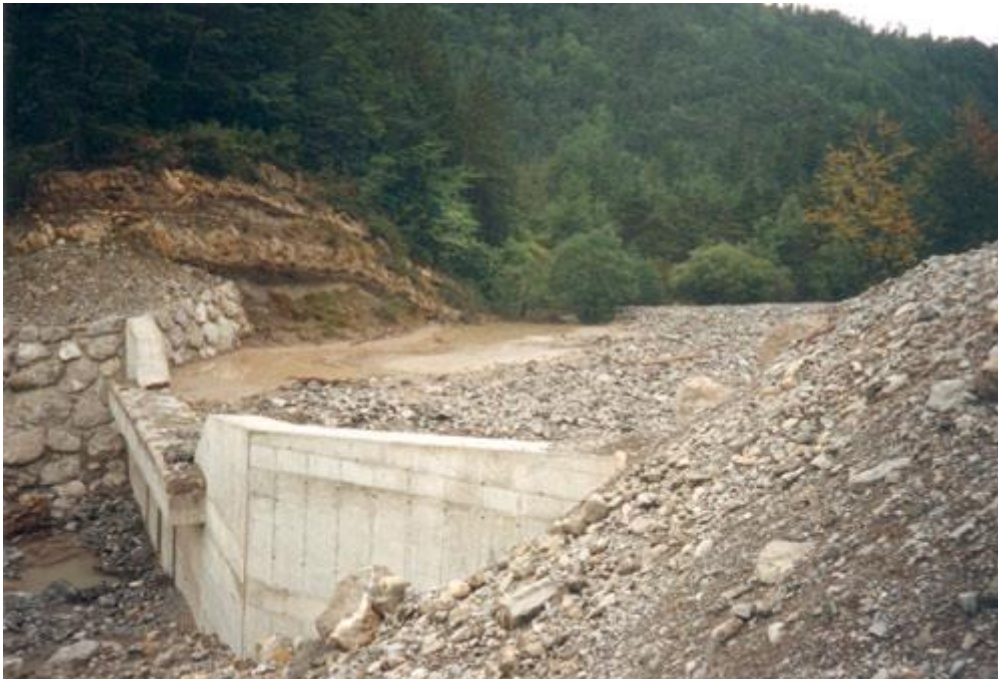
Figure 12 : Plage de dépôt remplie après la crue de 1992 (IRMA, 1992)
