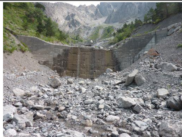
Photo JBN 2012. Depuis 2013 le B14 est quasi intégralement recouvert de matériaux
