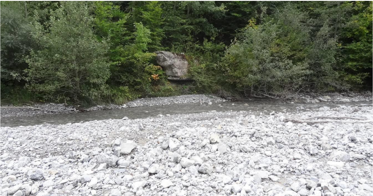
Photo 87 : Épi déchaussé en rive gauche de l'Ebron en aval de Château Bas.
