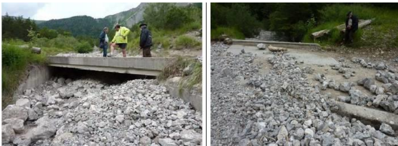
Figure 131 : Pont ayant fonctionné comme un seuil lors de la crue de juillet 2013.
