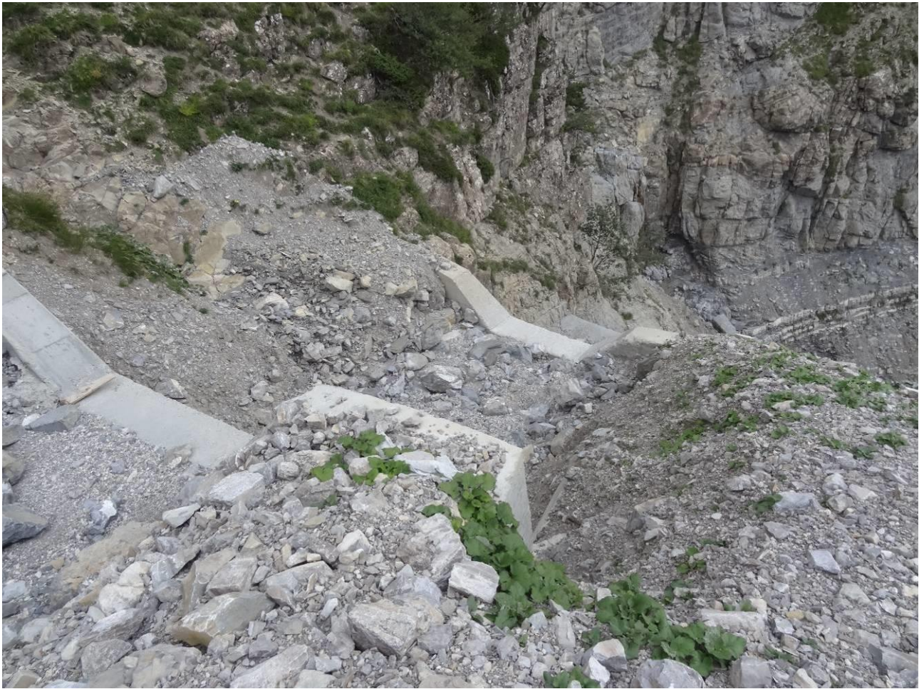
Photo 62 : Seuils en aval de la dérivation des Allières.
