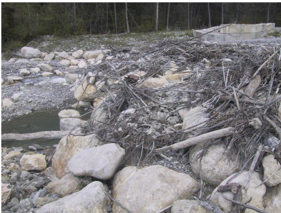
Seuil des Orgines en mai 2005 (affouillement des enrochements câblés) :
