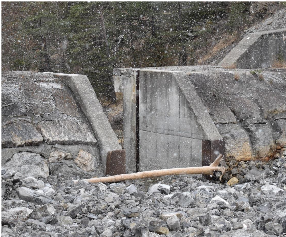
Figure 8 : Glissière verticale sur l'ouvrage de fermeture de la plage de dépôt (Amétén, fév. 2020)
