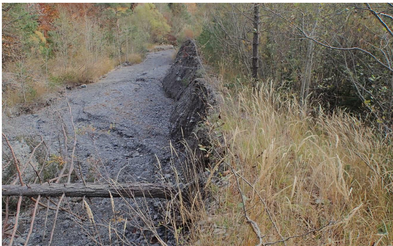
Photo 5 : Digue du Rattier érodée.
