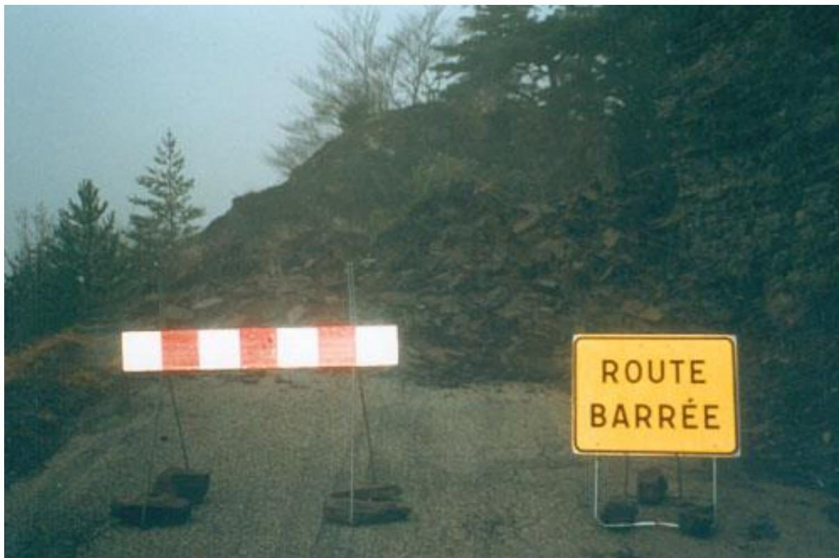
Figure 80 : Avril 1996, glissement du pieds de talus
