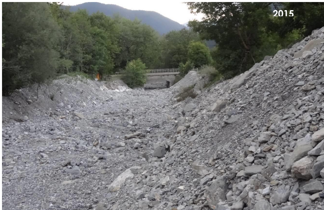
Photo 53 : Faible section du pont du Serre.
