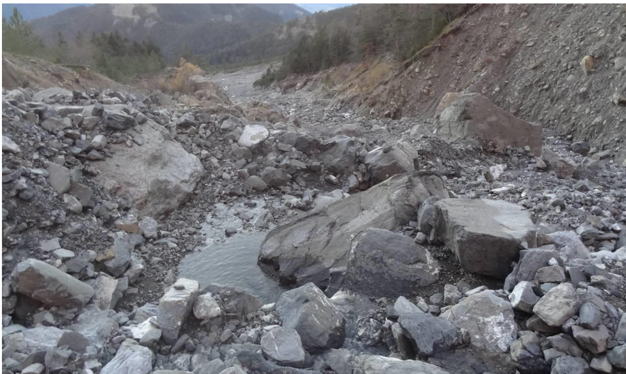
Photo 93 : Confortement du pied d'éboulis.
