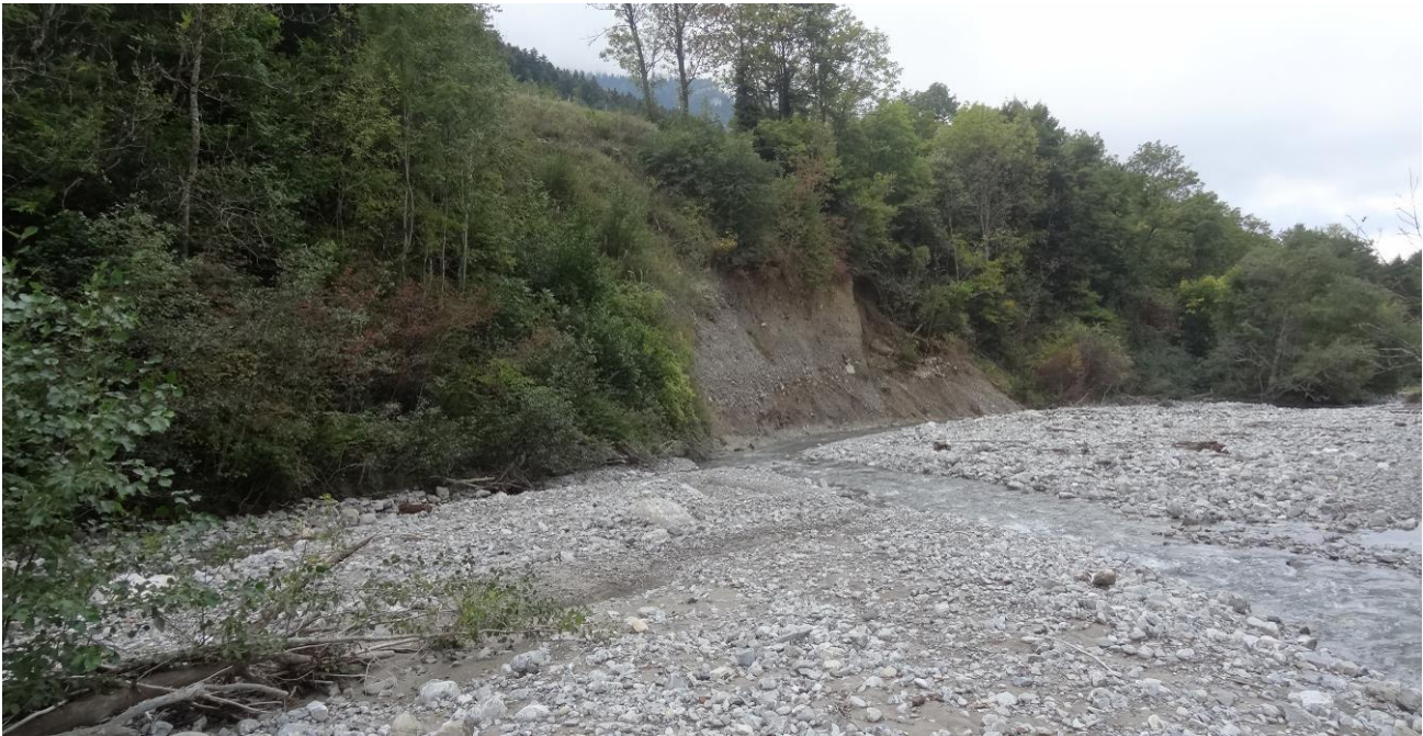
Photo 88 : Érosion le long de la RD 216.
