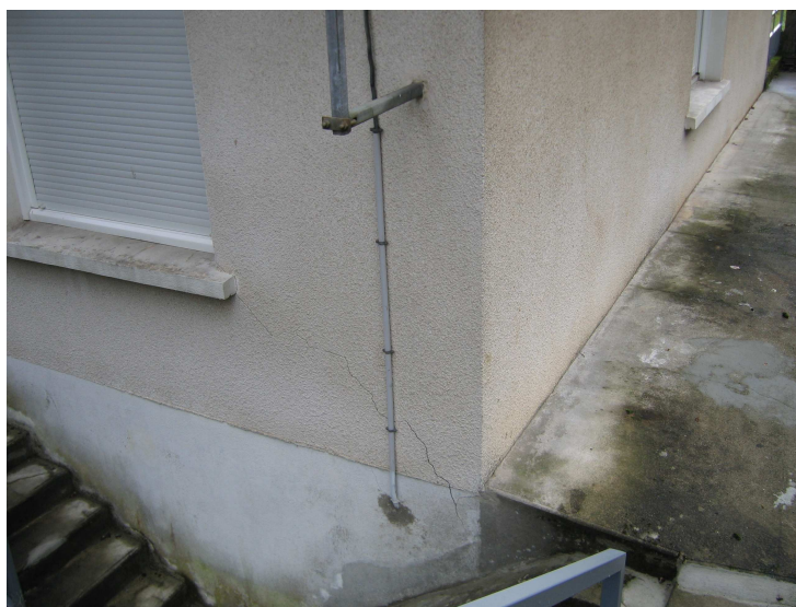
Figure n°19 : Fissuration de l'angle N.W. de la maison au n°11 rue Ravel
