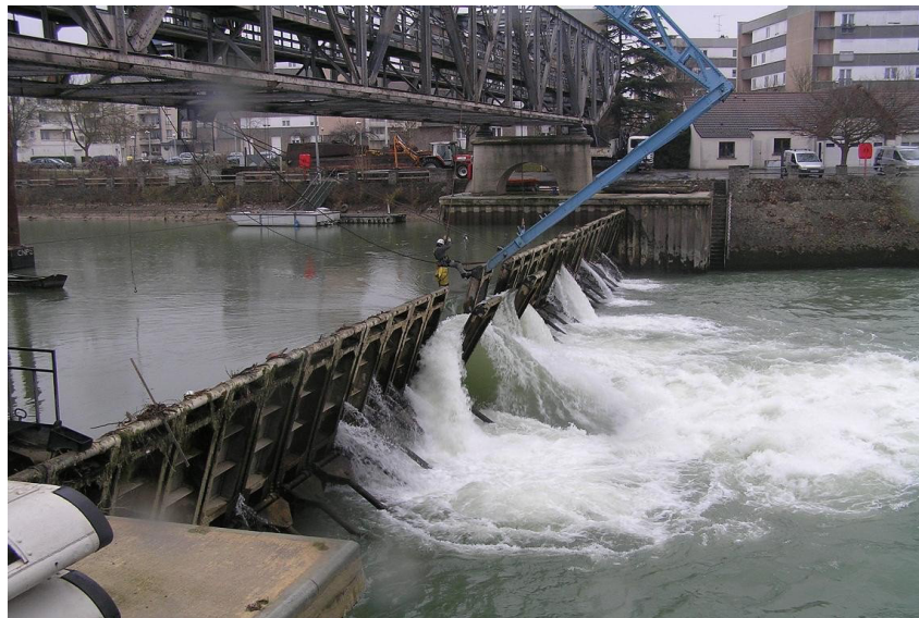
Barrage de Meaux : trois hausses contiguës de cet ouvrage mobile à hausses Aubert se sont affaissées
