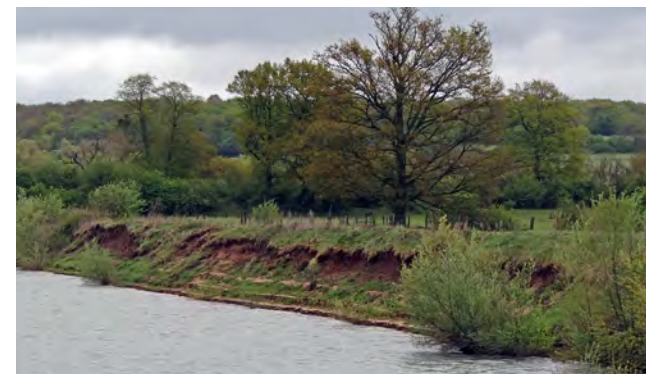
Les pentes des berges doivent proposer des profils le moins raides possible, d'autant que le niveau de la nappe alluviale variant, des berges raides amènent à se retrouver sur des talus très importants lorsque le niveau de la nappe est bas
