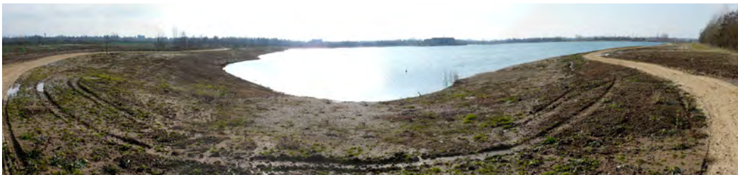
Sablière en cours de réaménagement, avec des pentes douces et un paysage ouvert autour de l'eau
