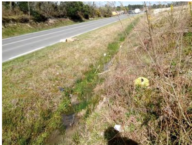
Photographie 2 : Fossé dégradé en bordure de route (Source : Simethis)
