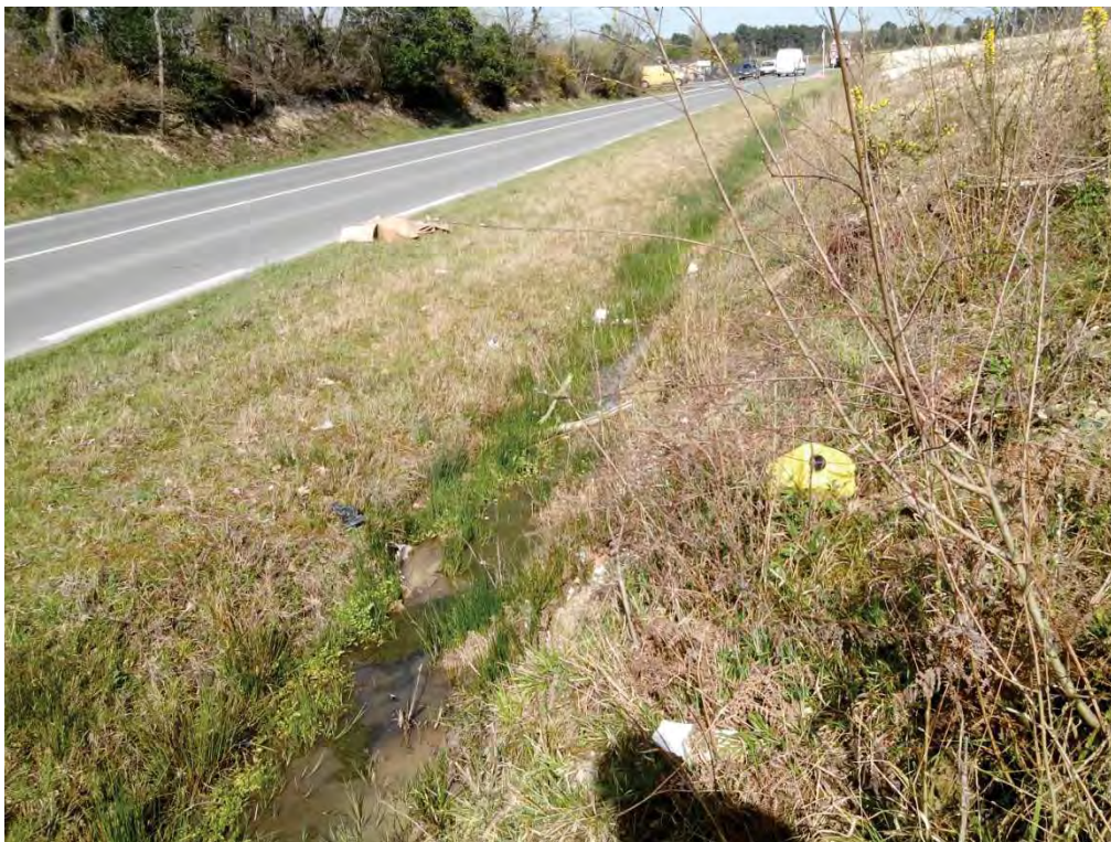
Photo 2 : Fossé dégradé en bordure de route (Source : Simethis)
