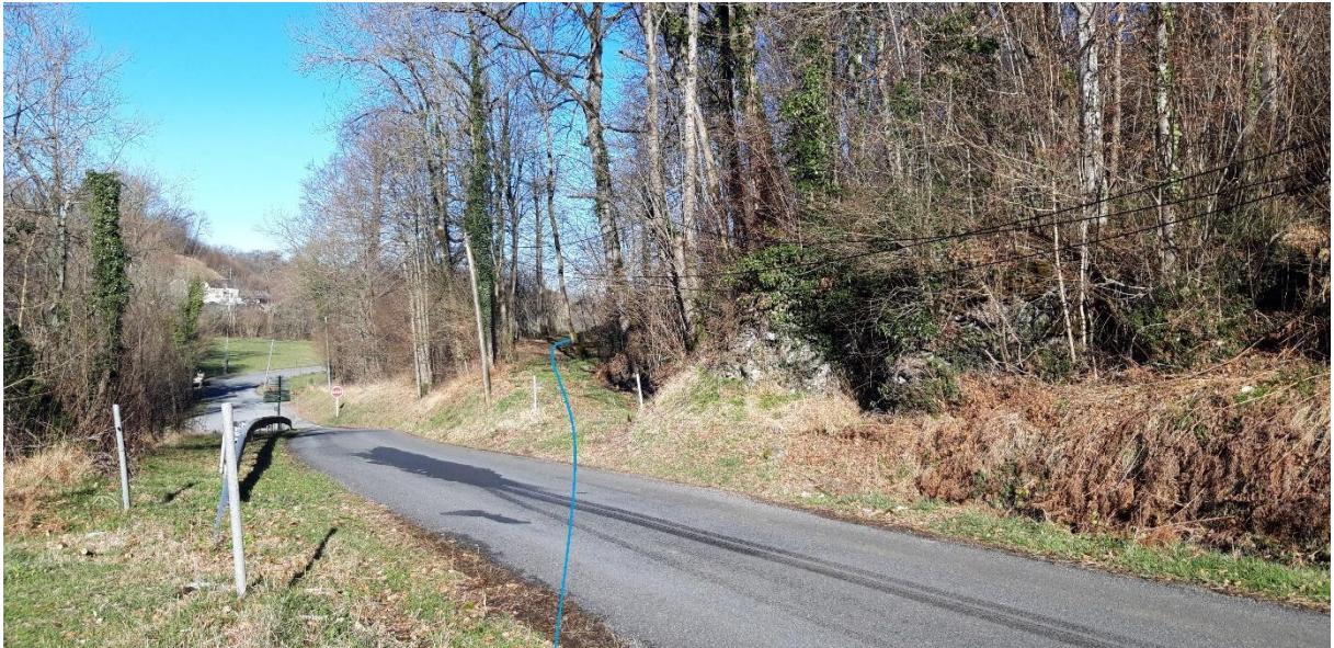
Tronçon n°46 et 47
