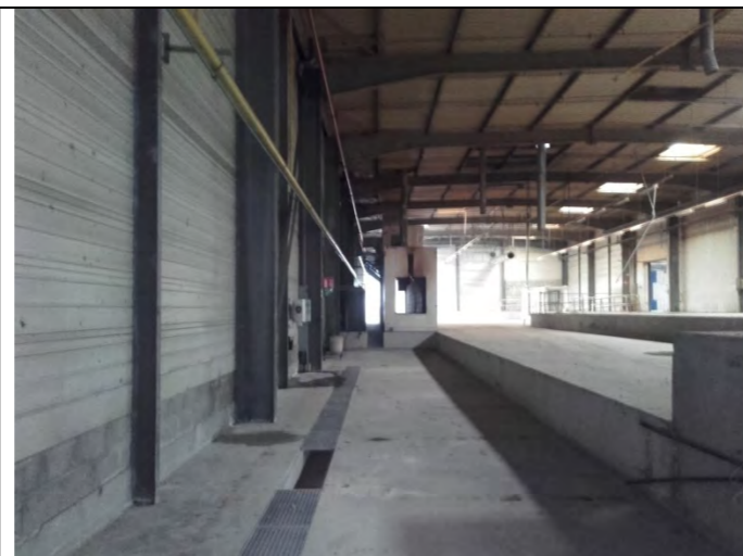
Tunnel de traitement de surface et rétention en béton
