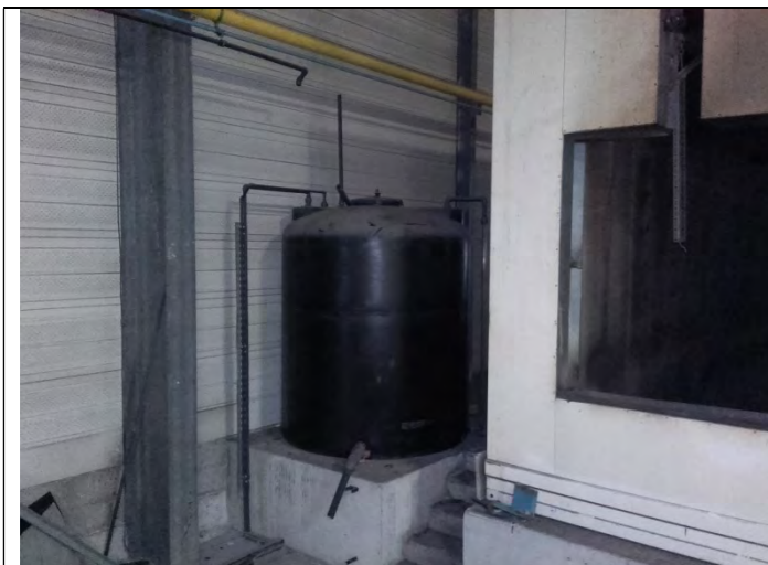
Tunnel de traitement de surface du poudrage (cuve eau osmosée)
