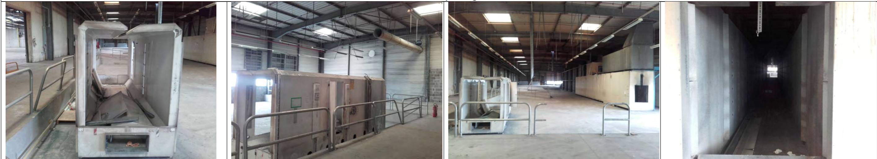
Cabine de poufrage Cabine de poufrage Vue générale de l'atelier de poufrage Tunnel de traitement de surface du poufrage
