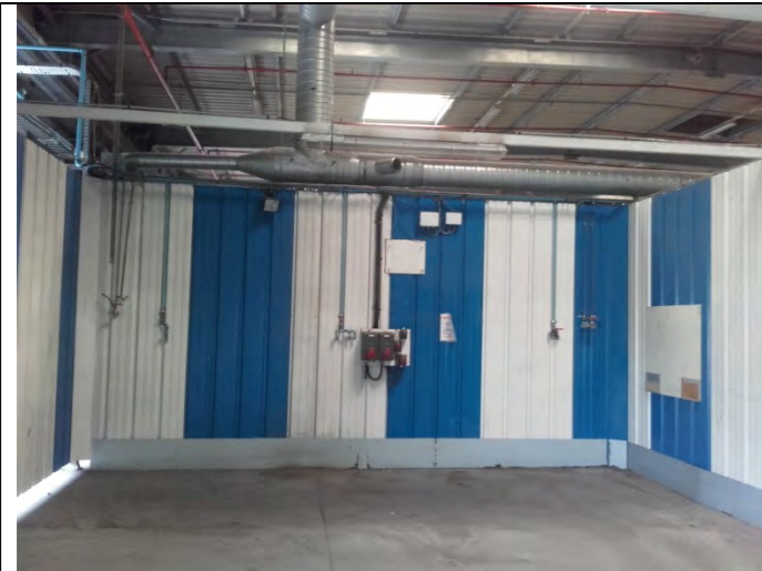
Ancien poste à soudure
