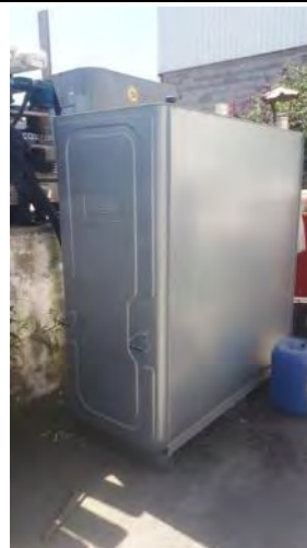
Photographie 6 : Cuve aérienne de stockage de fioul
