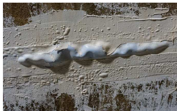
Détail sur boursouffures gorgées d'eau
