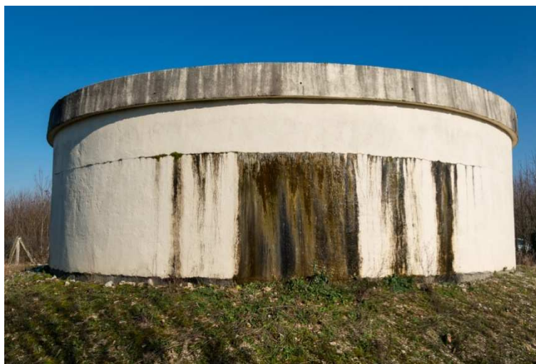
Fuite périphérique sur voile circulaire
