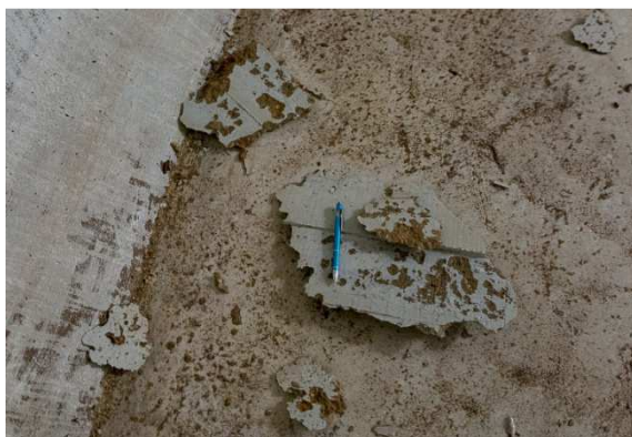
Morceaux de béton tombés de la coupole
