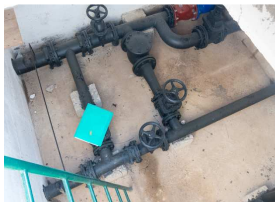
Chambre de vannes vue intérieure
