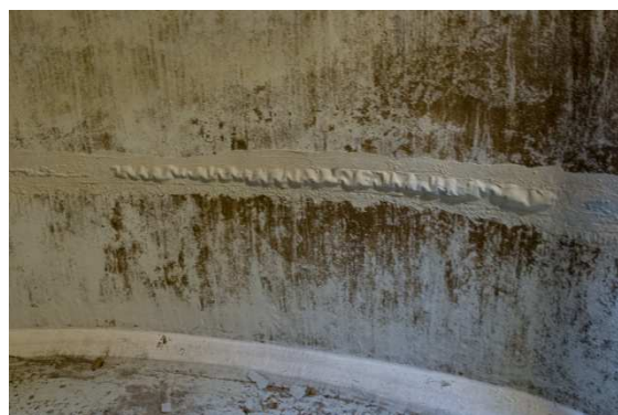
Boursouffures sur étanchéité périphérique
