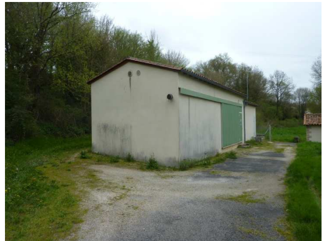
Station de traitement de Vieux-Ruffec
