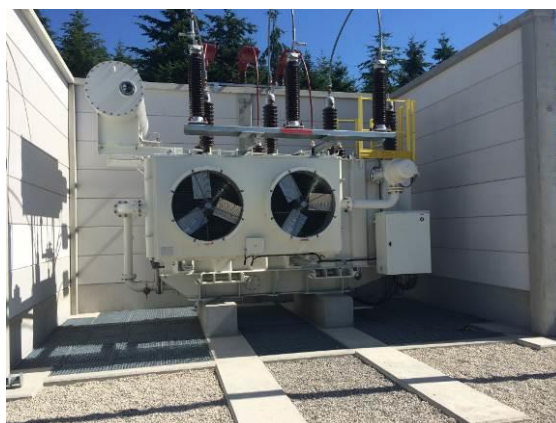
Exemple de transformateur
