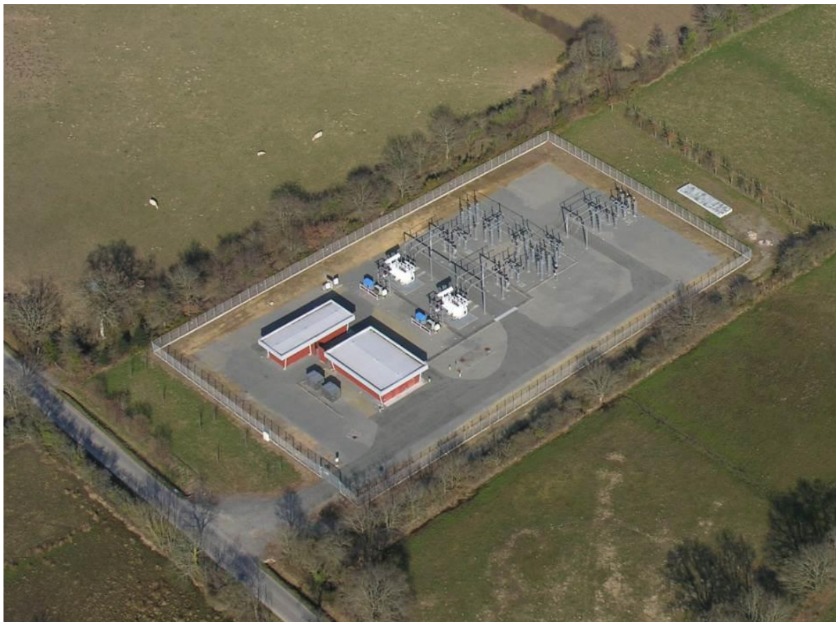
Exemple de poste de transformation
