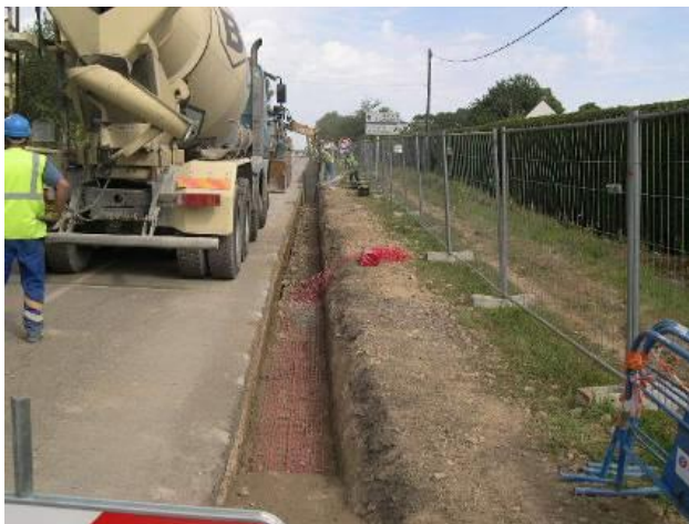
Illustration 20 : Exemple de signalement des câbles par un grillage avertisseur
