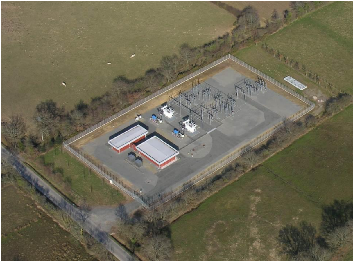
Illustration 9 : Exemple de poste de transformation
