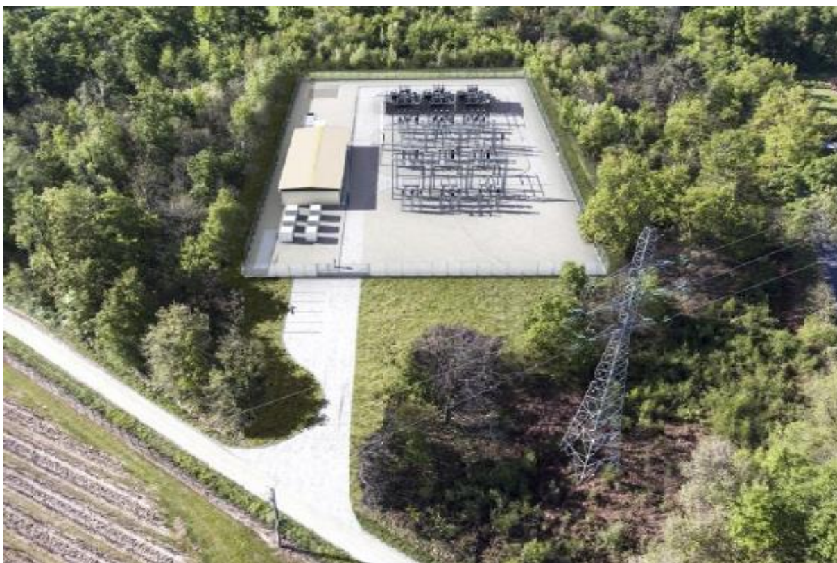
Illustration 6 : Exemples de poste de transformation
