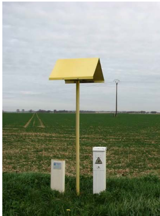
Photo 26 : Borne et balise d'une canalisation existante Source : GRTgaz
