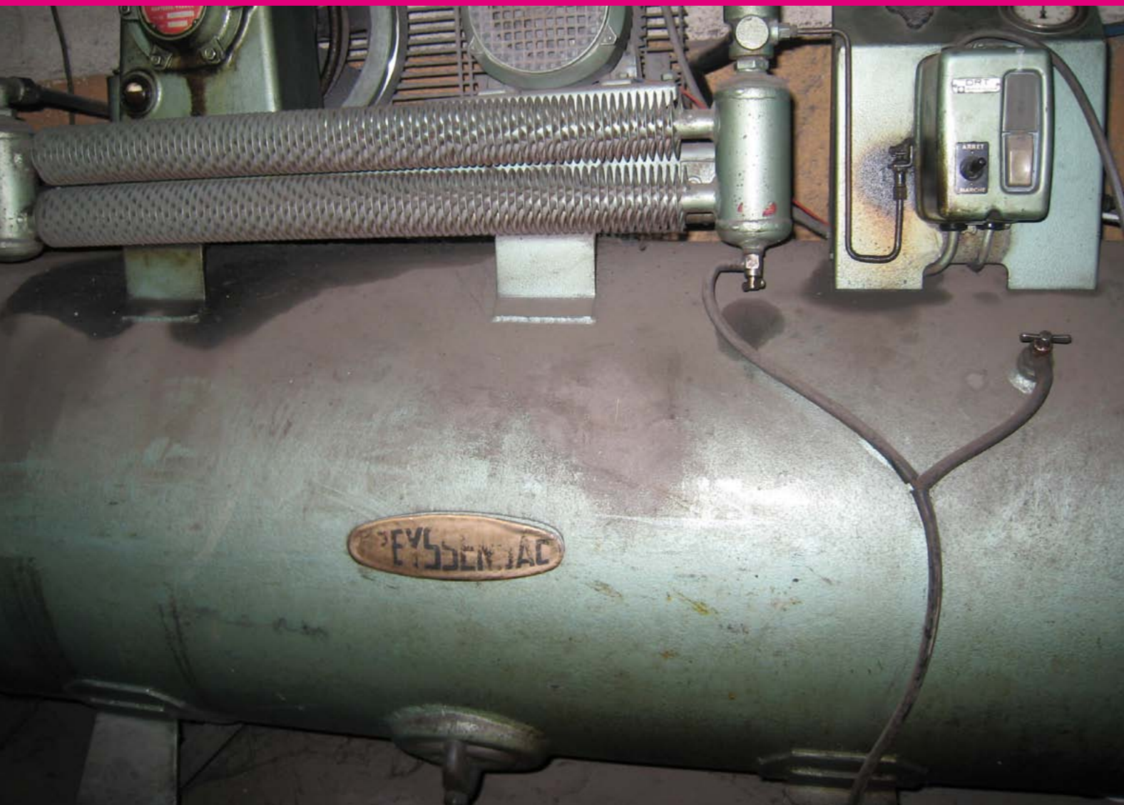
Compresseur à air comprimé dans un garage automobile
