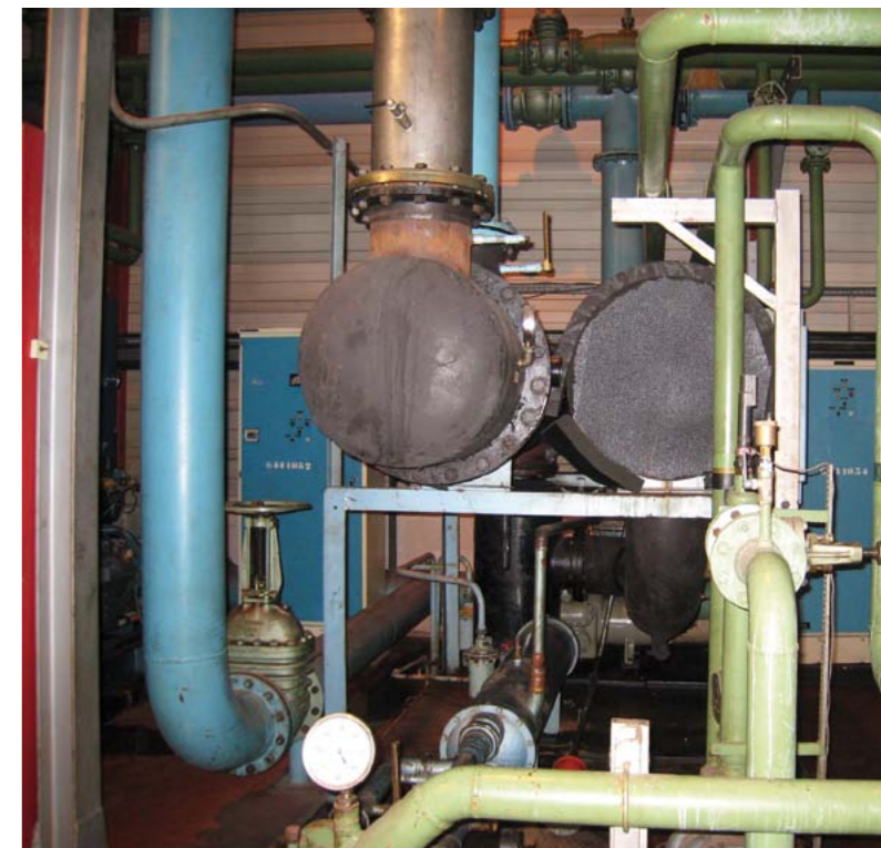
Echangeur et tuyauteries
