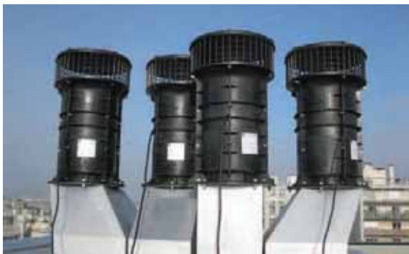
Conduits de ventilation naturelle assistée
