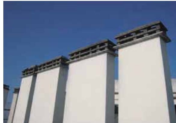
Conduits de ventilation naturelle
