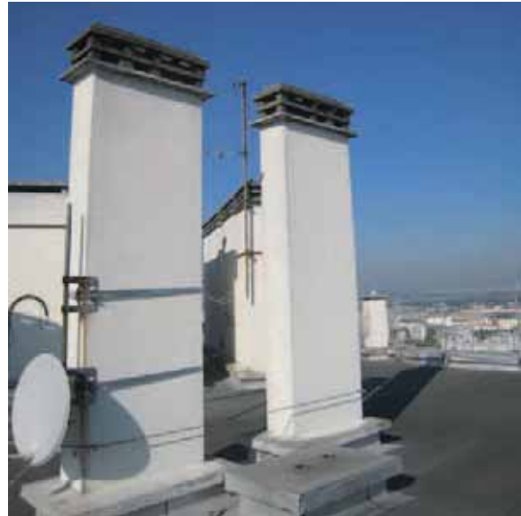
Conduits de ventilation naturelle
