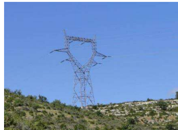
Ligne haute tension traversant le plateau de Rompon
