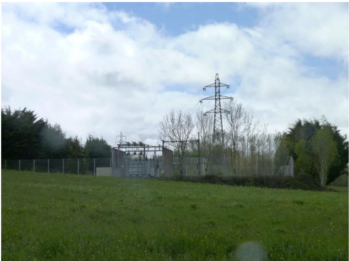
Figure 5 : Vue sur le poste électrique et les haies de Thuya, A. HILAIRET © EODD 2021
