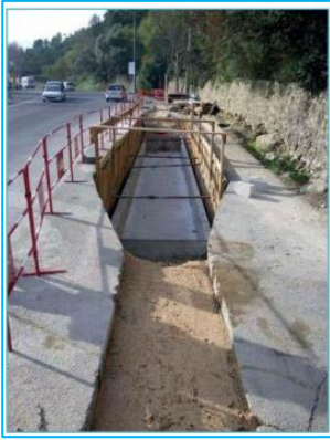
Figure 8 : chambre de jonction
