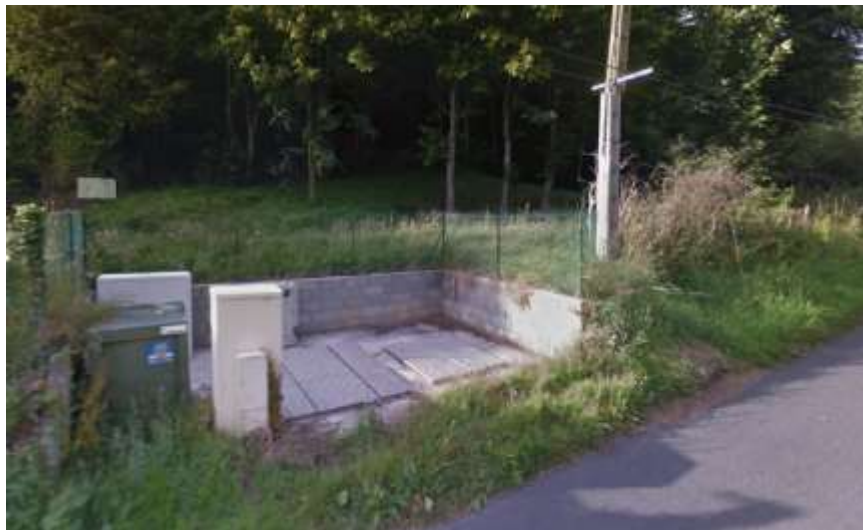
Figure 74 : Poste de refoulement PR « Bruneval 2 » avenue du Colonel Rémy
