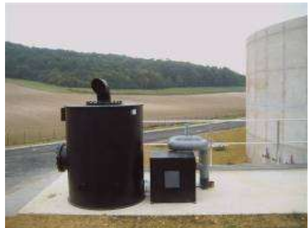
Cuve de traitement par charbon actif
