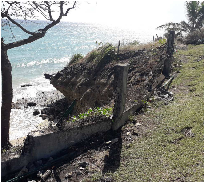
Figure 10 : Cheminement au-dessus de la falaise sur les parcelles K 166 et K 168 (Source : SUEZ CONSULING, 2020).
