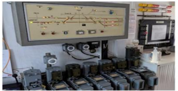
Photo 4 : TCC et VCM du Poste 1 d'Arcachon
