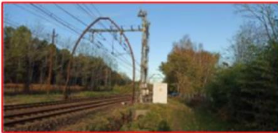
Photo 8 : Vue du Poste de mise en Parallèle direction Bordeaux
