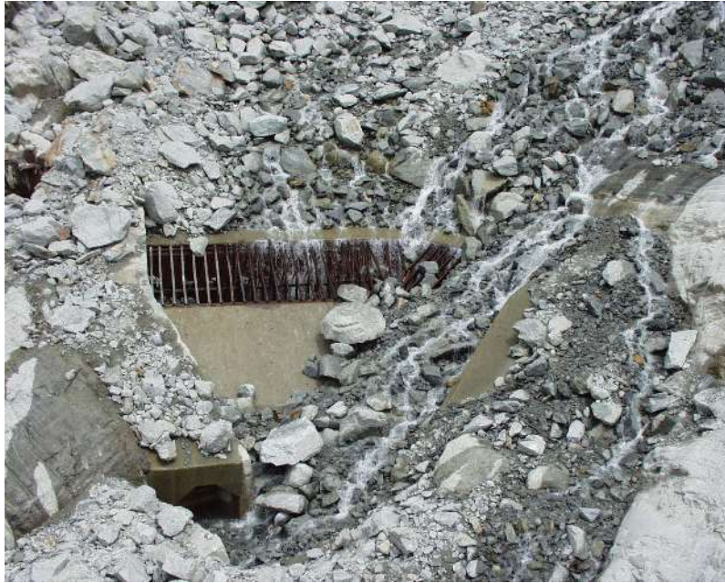
Exemple de protection de captage aérien du Tour (Emosson)
