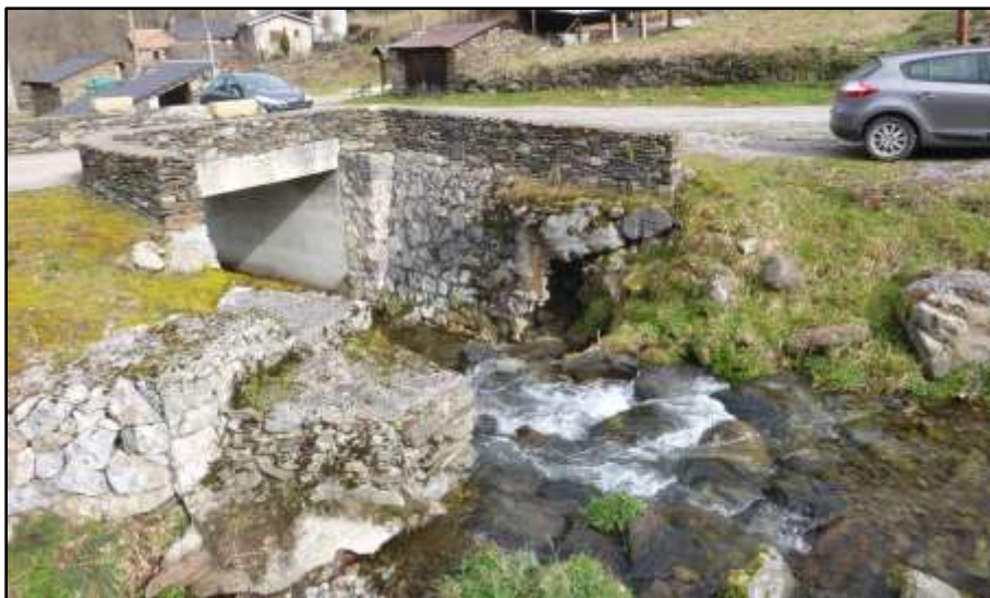
Figure 9 : Parement déchaussé du mur de soutènement du pont d'Artiès (source : AGERIN SAS )
