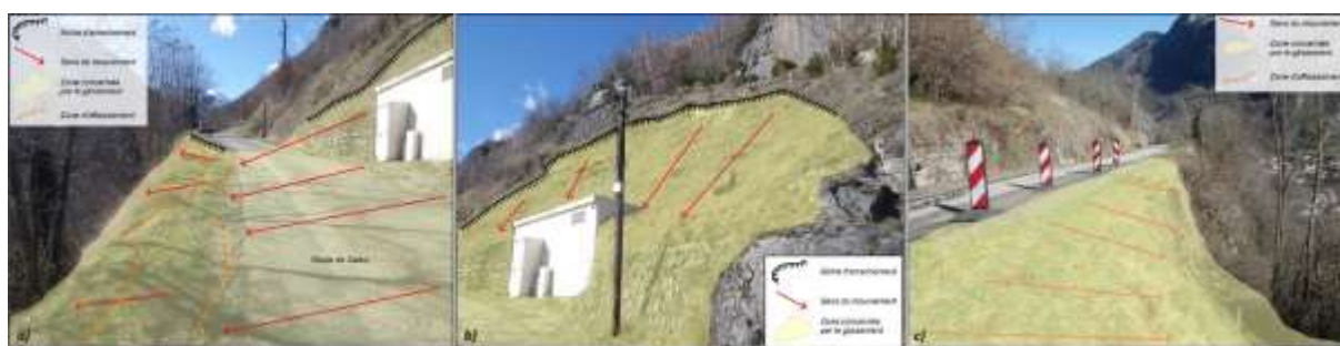
Figure 40 : Niche d'arrachement et signes d'affaissement visibles le long de la route de Saleix (a et b). Balisage routier en place à cause d'un affaissement de la route (Source AGERINSAS)
