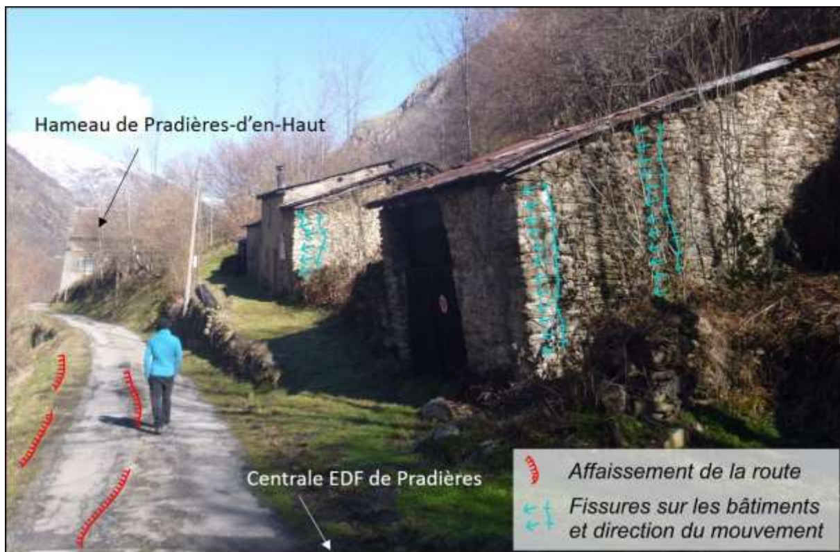
Figure 373 : Habitations situées en zone d'aléa fort de glissement de terrain (Source AGERIN SAS ).
