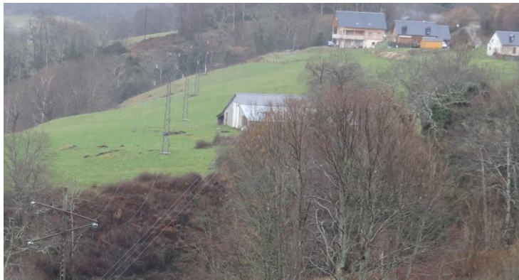
La ligne à 63 000 volts à proximité des Sosses (Hèches)
