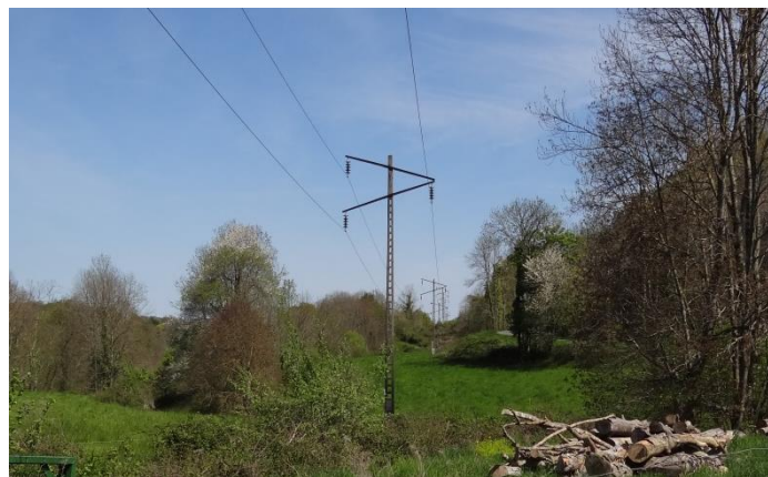
La ligne aérienne à 63 000 volts dans les boisements
