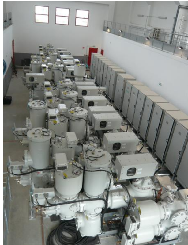
Poste sous enveloppe métallique en bâtiment
