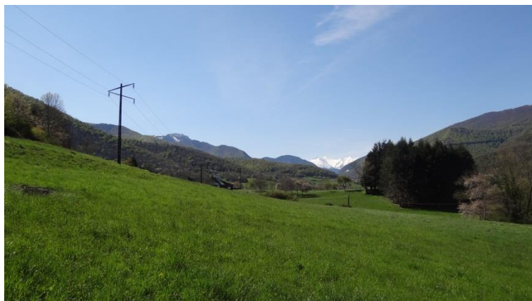
La ligne existante à 63 000 volts à proximité d'Héchette
