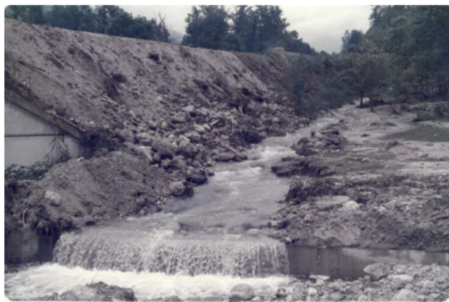
Écoulement le long du remblai de la RN 20
