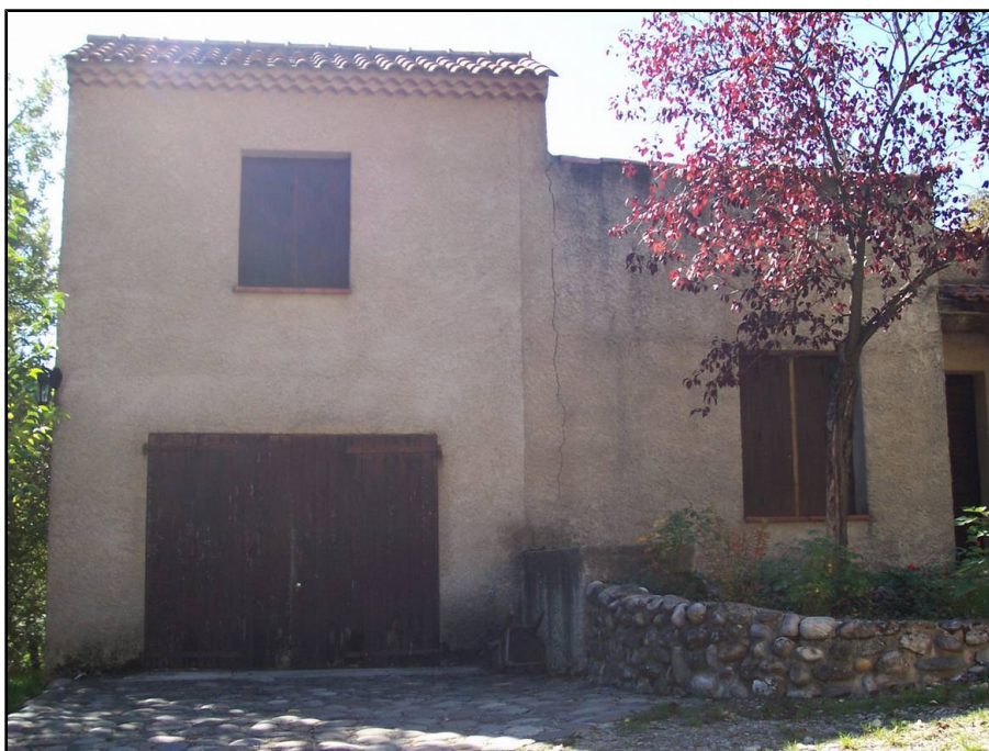
Figure 25: Construction du hameau des Itardes – une fissure est visible à la jonction entre deux parties de la bâtisse. Cette fissuration apparaît caractéristique des phénomènes de retrait/gonflement et pourrait être favorisée par l'absence de joint de rupture entre les deux parties de structure. Une cause autre ne peut cependant être exclue.
