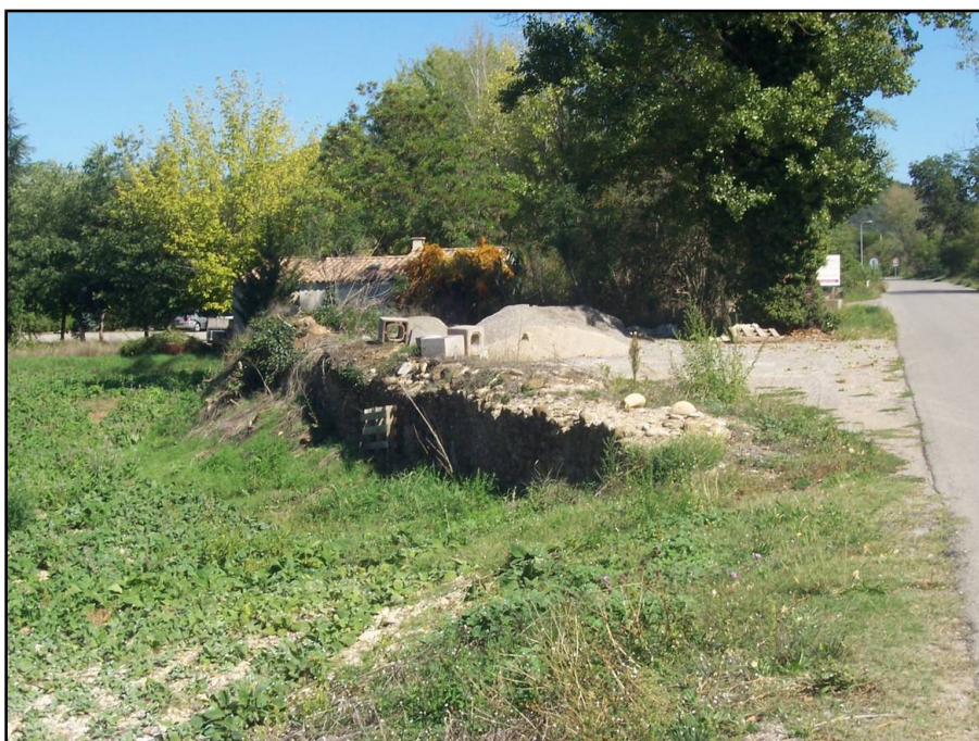
Figure 12: Digue en aval immédiat de l'hôtel Le Grand Pré La déviation a été réalisée en empiétant dans ce secteur dans le lit du torrent.
