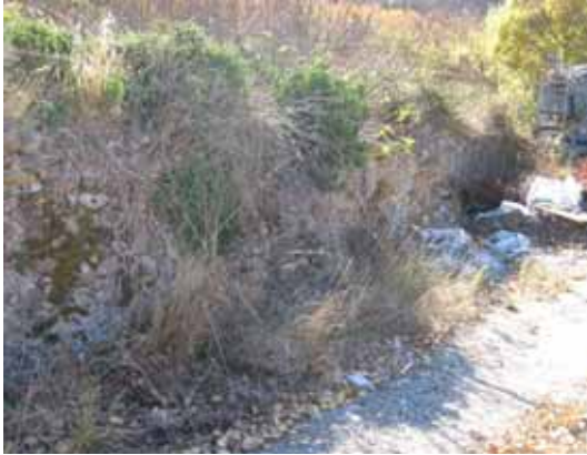
Vieille digue en pierre, ruinée
