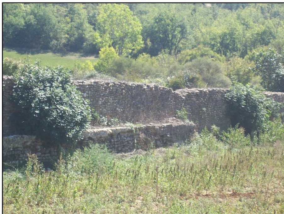
Figure 11: Vue rapprochée du mur-digue au niveau de la confluence Puimichel/Rancure.
