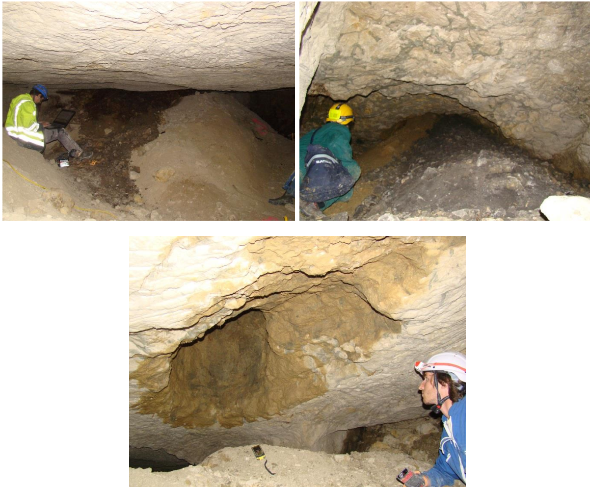
Illustration 13 : En haut, cônes d'éboulis liés à la remontée en surface de cloches de fontis, ayant induit un effondrement en surface, remblayé par du tout venant (notamment des scories). En bas, cloche de fontis liée au déboufrage d'un conduit karstique vertical, calé sur une fracture naturelle
