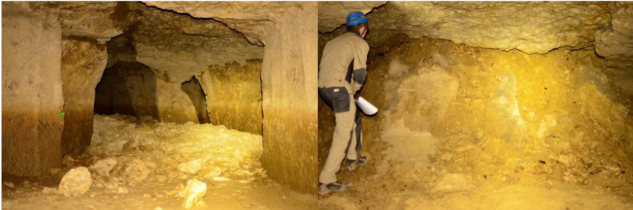
Illustration 19 : Illustration des deux types d'instabilités de toit : à gauche, les chutes de toit et à droite, un éboulis lié à la remontée d'une cloche de fontis – carrière de Loisail « Le Bas Champailaume »
