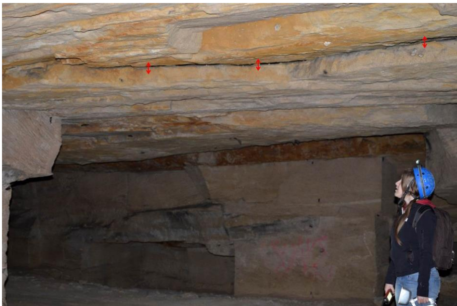
Illustration 20 : Illustration d'une zone de décollement de 1 er banc de toit dans la carrière de Béný-sur-Mer « Le Rocreux »
