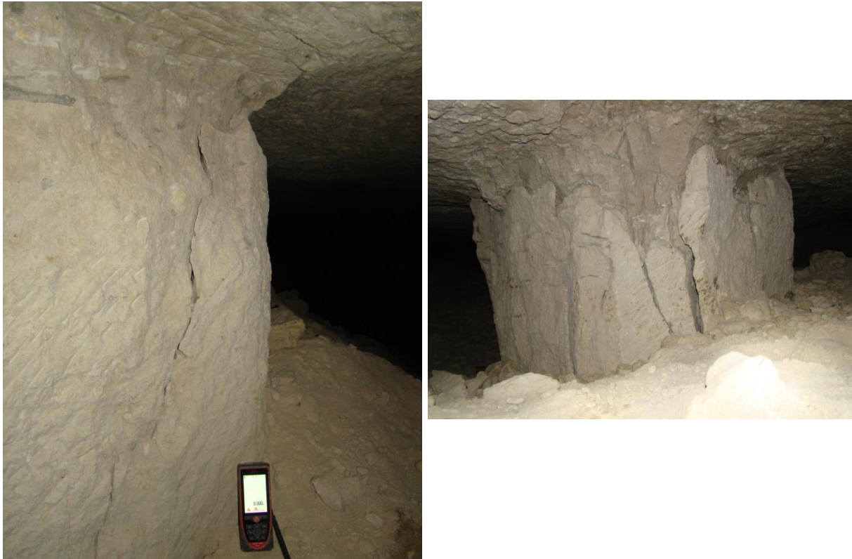
Illustration 15 : A gauche, pilier écaillé et à droite, pilier totalement fracturé, considéré en état de post-rupture (probablement maintenu par les remblais)
