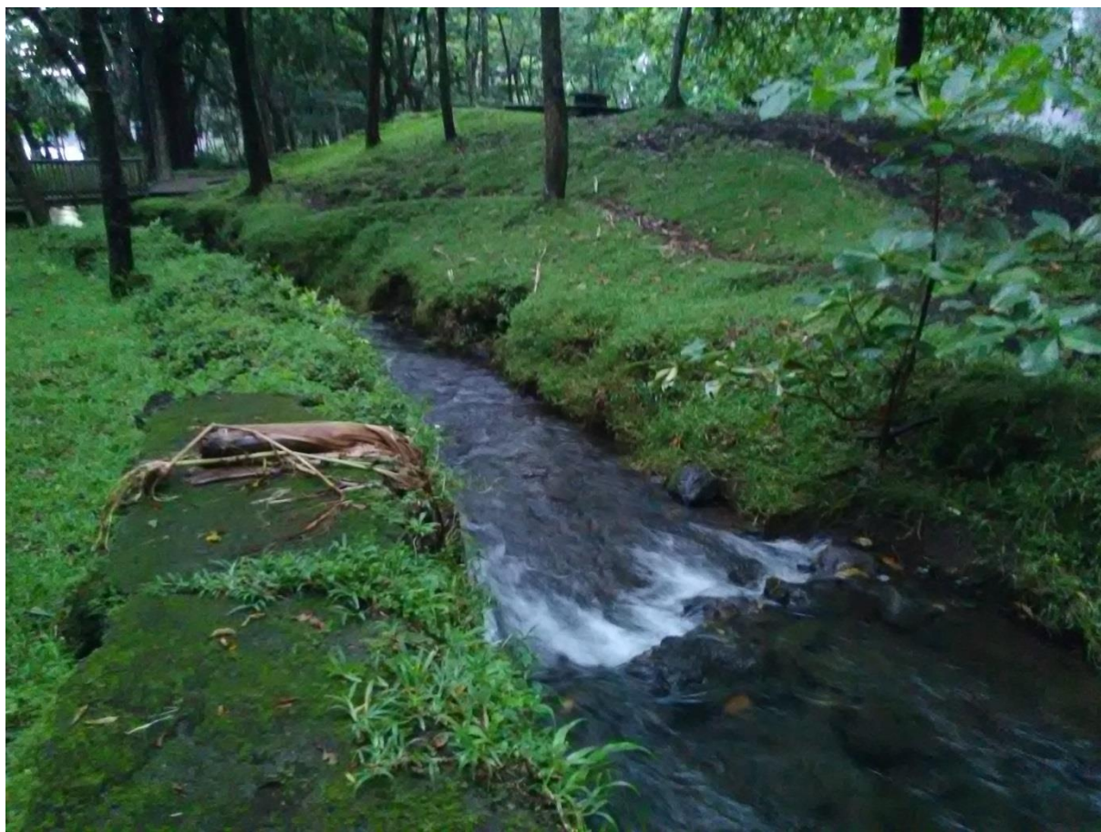
Figure 12 : Photos de la ravine principale et d'ouvrages en maçonnerie moellon (Source EGIS 2018).
