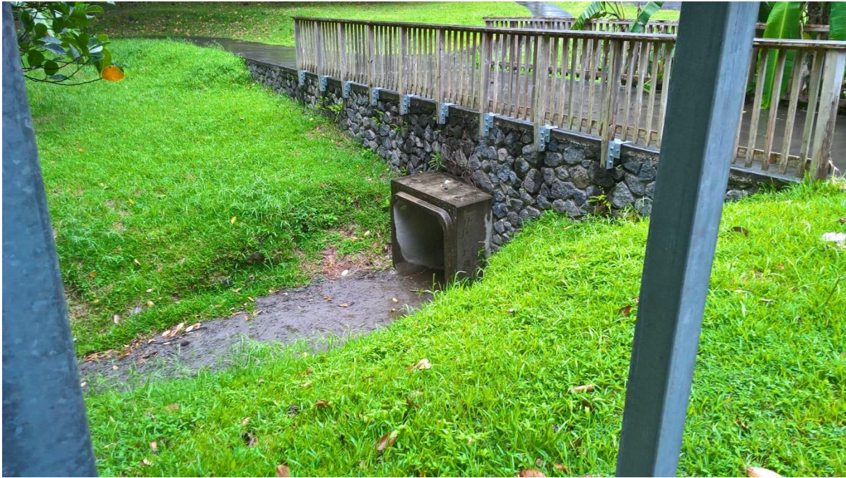
Figure 13 : Photos de la ravine secondaire (Source EGIS 2018).
