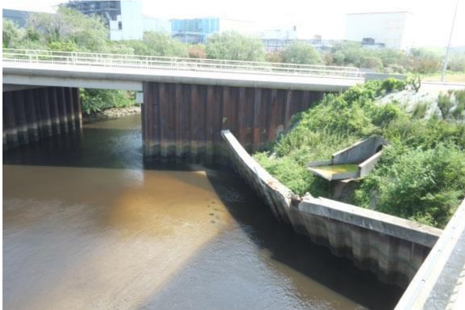
Déversement du rideau de palplanche en amont de la station de Marck
