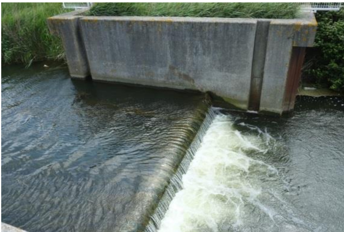
Clapet de Marck en position partiellement levée
