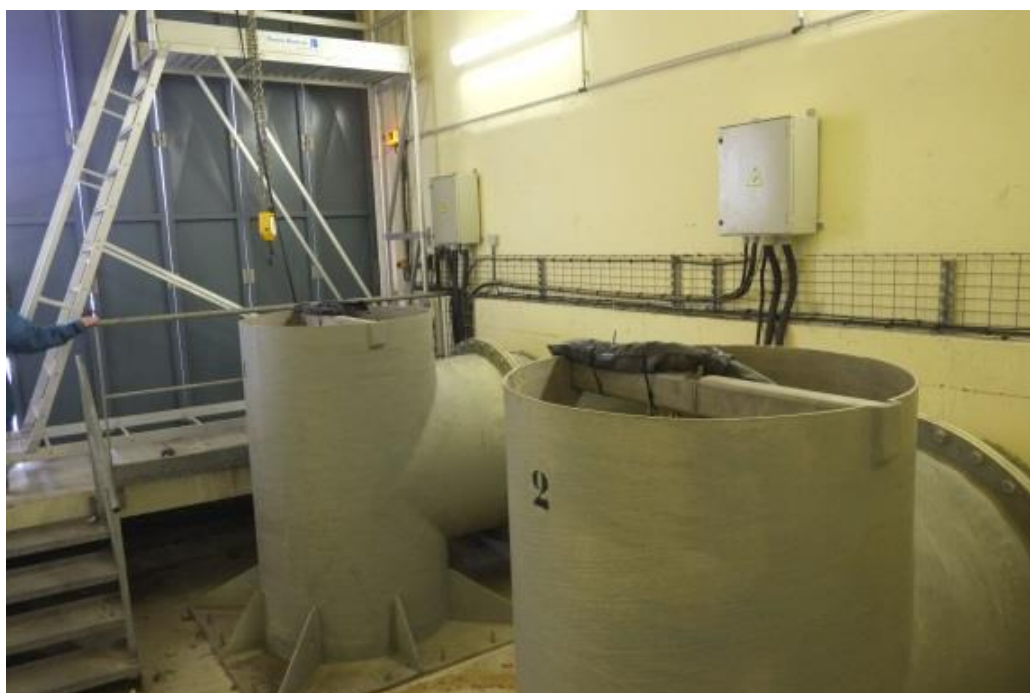
Pompes Flygt de la station Batellerie
