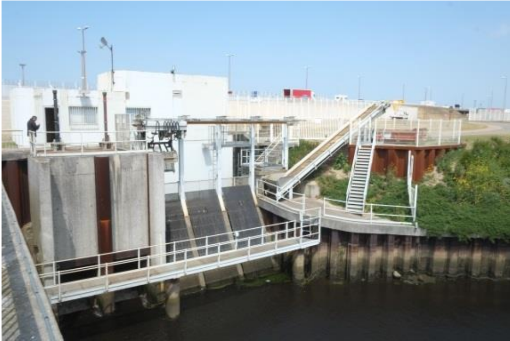
Figure 9 : Station de Marck – vue générale, pertuis gravitaires, grilles, dégrilleurs.
