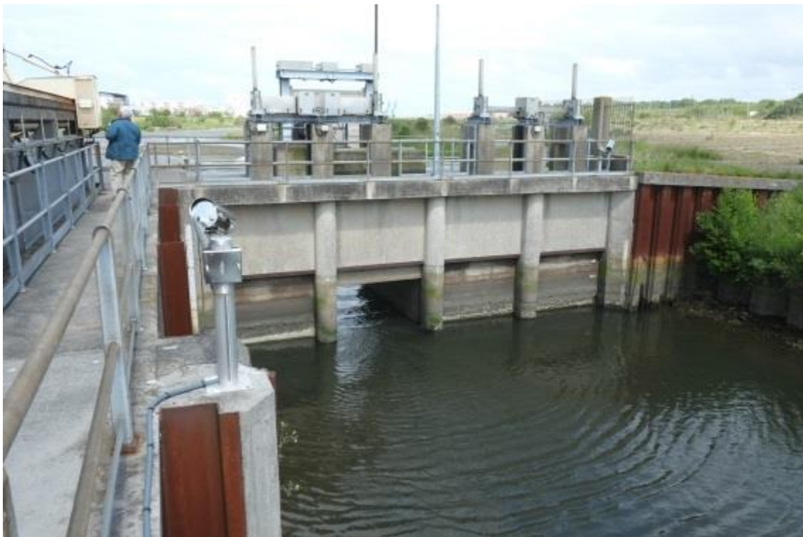
Figure 8 : Station des Pierrettes – vannes gravitaires.
