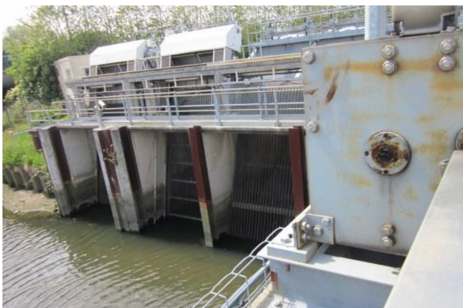
Dégrilleurs de la station des Pierrettes
