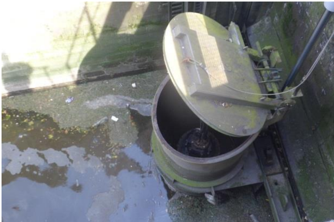
Figure 16 : Station des Moères (ou des 4 écluses) – pompe sur vanne, clapet ouvert.
