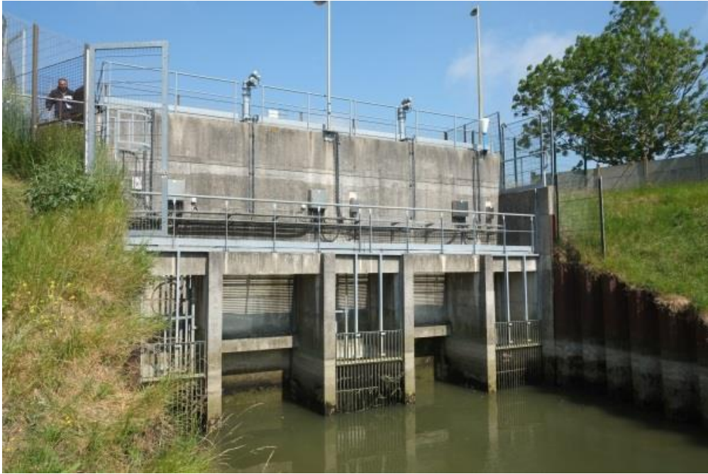
Station de la rivière d'Oye : 3 pertuis vannés amont et 2 pertuis de pompage
