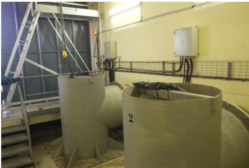
Figure 5 : Station de la batellerie – Pompes Flygt
