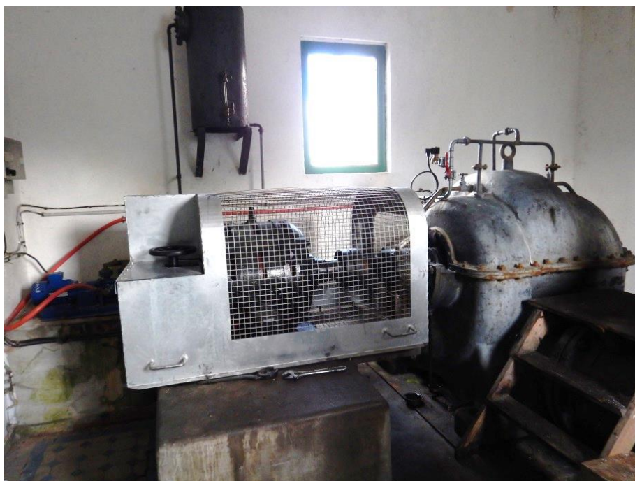
Figure 44 : Photo de la station de pompage du lac d'Ardres.
