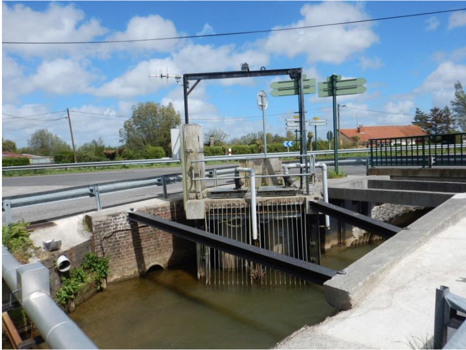
Figure 45 : Photo des dégrilleurs de la station de Balinghem.
