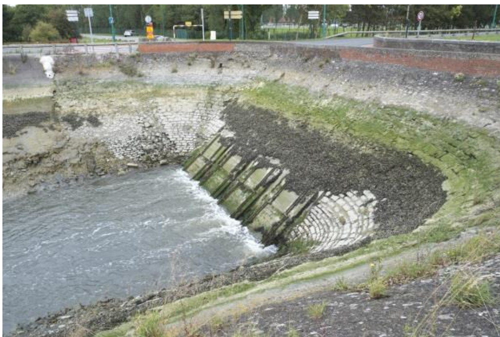
Figure 13 : Clapets du Schelfvliet.
