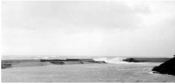
Figure 5 : Brèche dans la digue des Alliés à Dunkerque (littoral Dunkerquois-Nord) en février 1953.
