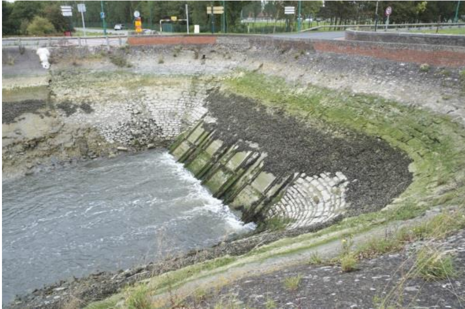
Exutoire du Schelfvliet – Clapets en bois
