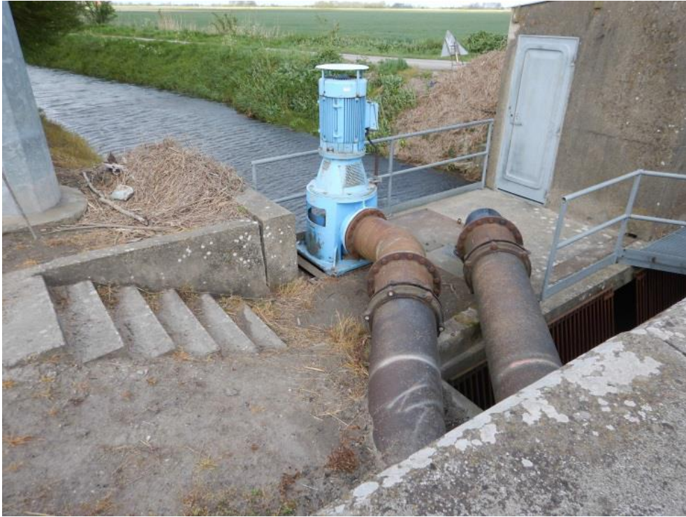
Figure 46 : Photo de la station de Pont Neuf (Nord).
