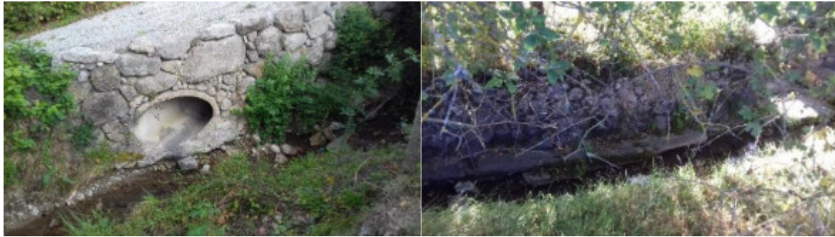
fig. 7 : Protections de berge, buses de rejet des eaux pluviales et affouillements des protections
