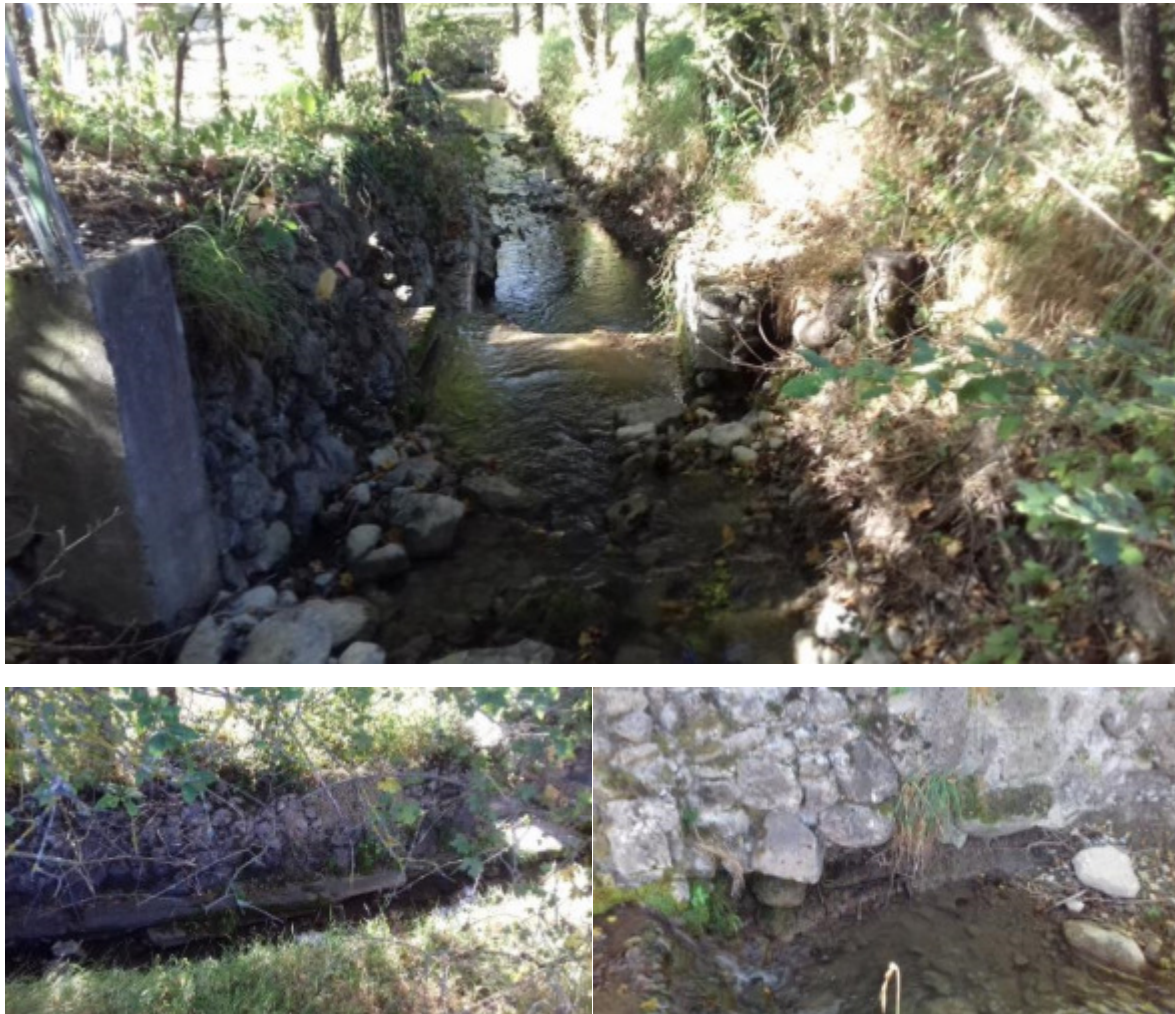
fig. 23 : Photos d'un des secteurs où le lit est très fortement contraint et où des affouillements sont présents
