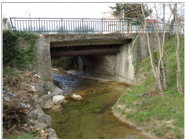
Figure 3.30: pont de la RD 624 ; on notera la canalisation fixée sous le tablier.
