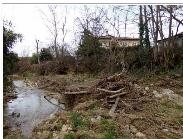
Figure 3.29: berges dégradées et présence d'embâcles à l'approche de la RD624.
