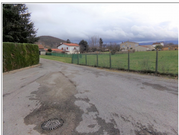
Figure 3.50: point bas à l'aval de l'avenue des Pyrénées (aval de la gare).
