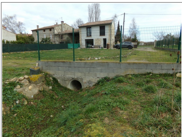
Figure 3.40: ruisseau de Malmarty à l'amont de la RD30. Il est busé sous une propriété sur quelques dizaines de mètres.
