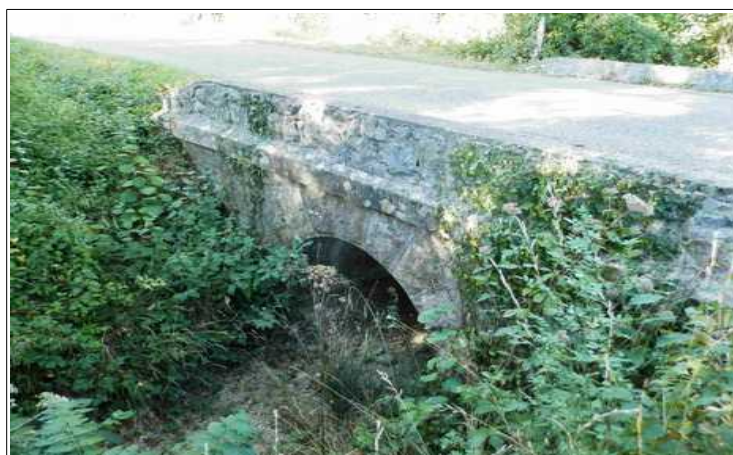
Figure III.5 : franchissement de la RD13 par le ruisseau de Martinayre.
