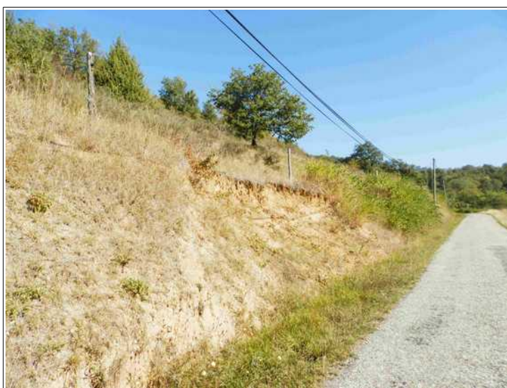
Figure III.13: glissement de talus le long de la RD713.
