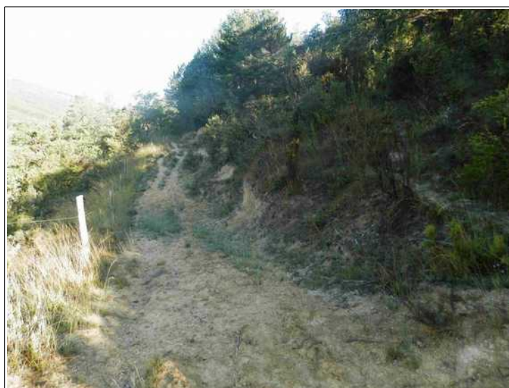
Figure III.14: Versant rive droite du Méridic au droit du hameau de Dieulafé. On notera en arrière plan l'aspect déformé du terrain, souligné par le chemin. Cette zone, probablement humide par intermittence, présente des signes de fluage.
