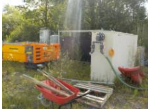
Unité de traitement en partie sud-est
