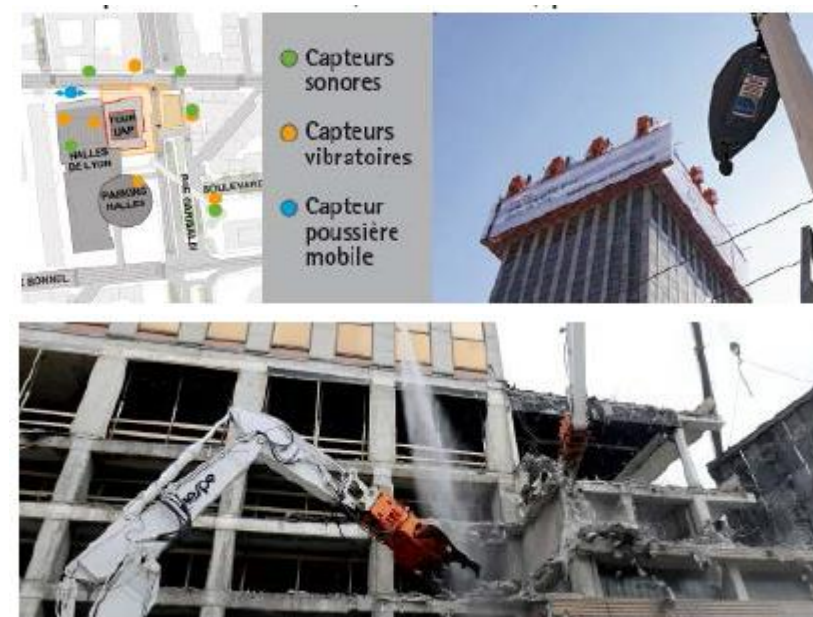
Figure 191 : Exemples de mesures mises en place dans le cadre du chantier de la Tour Incity : contrôle continu grâce à des capteurs (en haut), arrosage et micro-nébulisation pour limiter les poussières (en bas)
