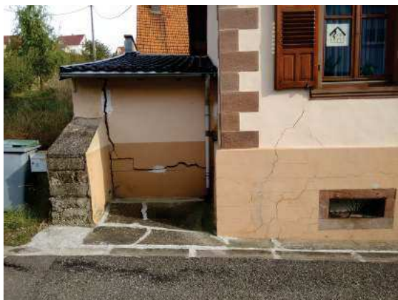
7. Dommages sur une maison ancienne
