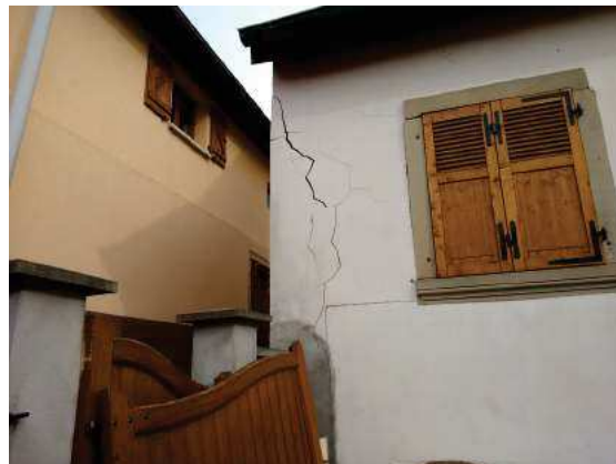
6. Dommages sur une maison ancienne
