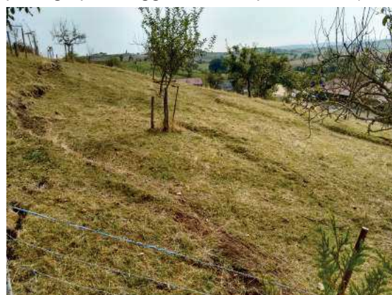
10. Crevasses ou fissures et « boutonnière » dans la colline du Koellberg (la photographie suggère la forte pente locale)
