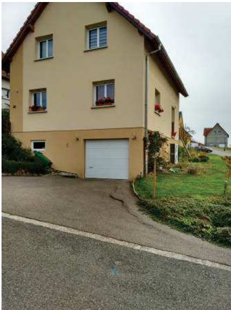
3. Dommages sur une maison moderne (sol fortement déformé devant le garage)
