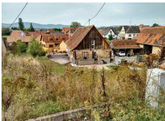
12. Une maison ancienne (fortement endommagée) « protégée » des déplacements horizontaux par un renfort des fondations avec des apports massifs périphériques de béton
