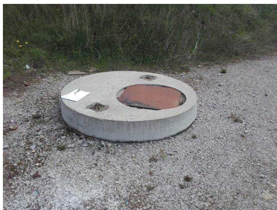
Figure 1. La tête du forage géothermique défectueux dans son état actuel
