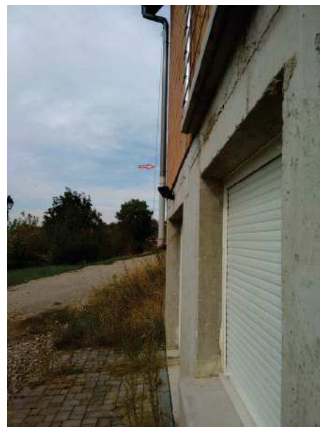
4. Dommages sur une maison moderne (remarquer le fil qui sert de « fil à plomb » devant la descente d'eau de la gouttière et indique la gîte)
