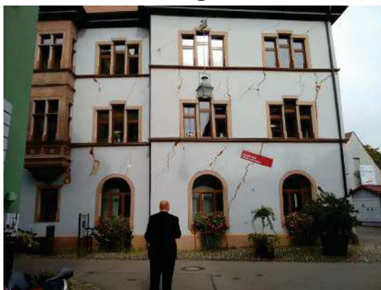
14. L'hôtel de ville très fortement endommagé
