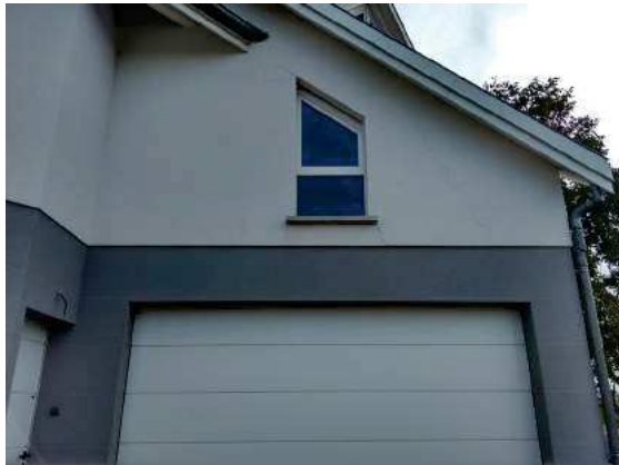
5. Dommages sur une maison moderne (fissures au-dessus du garage)
