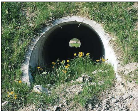
Exemple de passage inférieur à petite faune (type buse)
