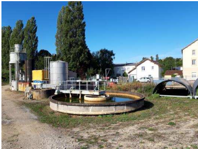
Photo n°5 : station d'épuration du site
