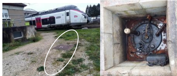
Photographie 10 : cuve de fioul domestique enterrée
