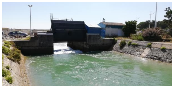
Vanne secteur du port du Douhet (Chenal du Douhet)
