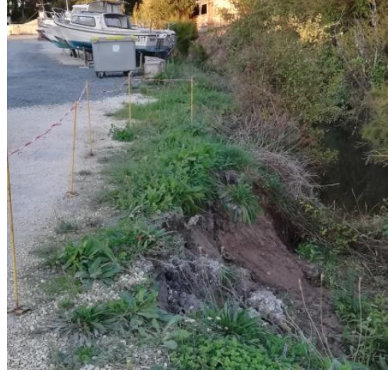
Erosion des berges du Riveau
