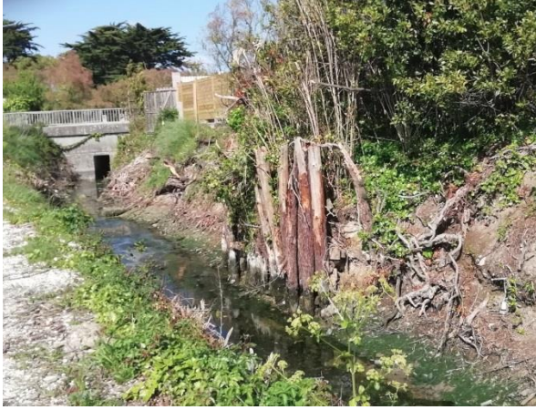
Berges érodées du Riveau
