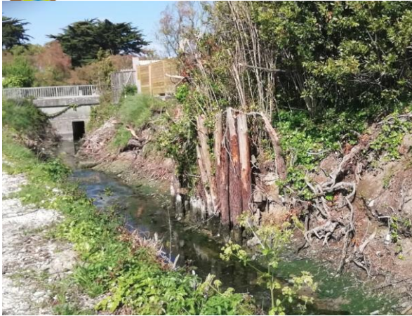
Berges érodées du Riveau
