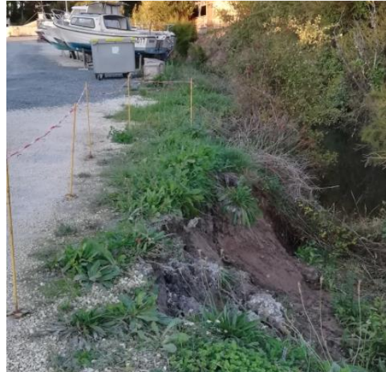
Erosion des berges du Riveau
