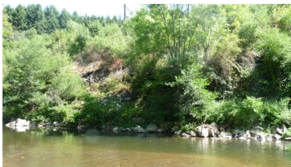
Désordres sur la zone 3
