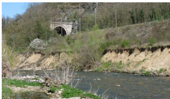
Désordres sur la zone 6
