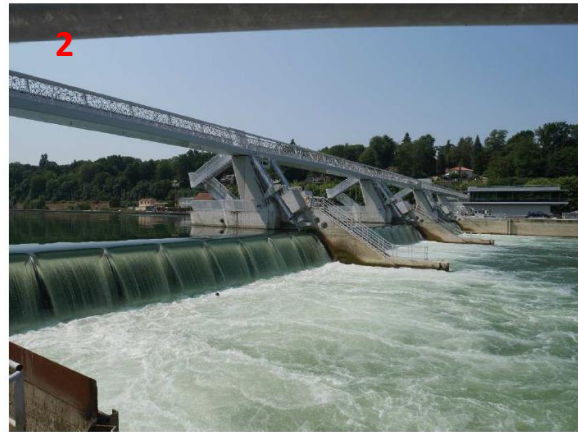
Barrage à clapets de Vives-Eaux, vue depuis l'aval en rive droite (Photo prise le 25/07/2018)
