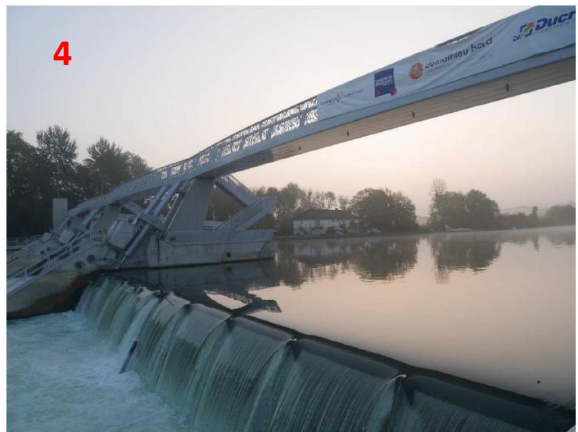
Clapet gauche du barrage de Vives-Eaux, vue depuis une pile du barrage (Photo prise le 18/10/2018)
