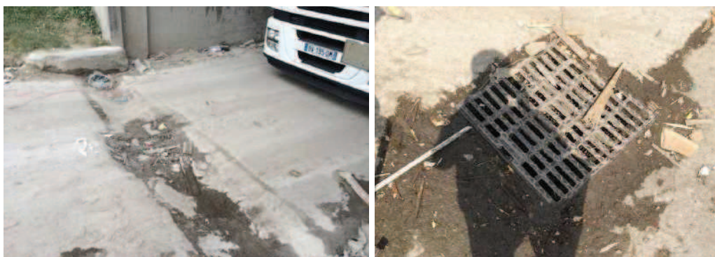
Photo 5-3 : Encrassement des avaloirs sur le site CDT
