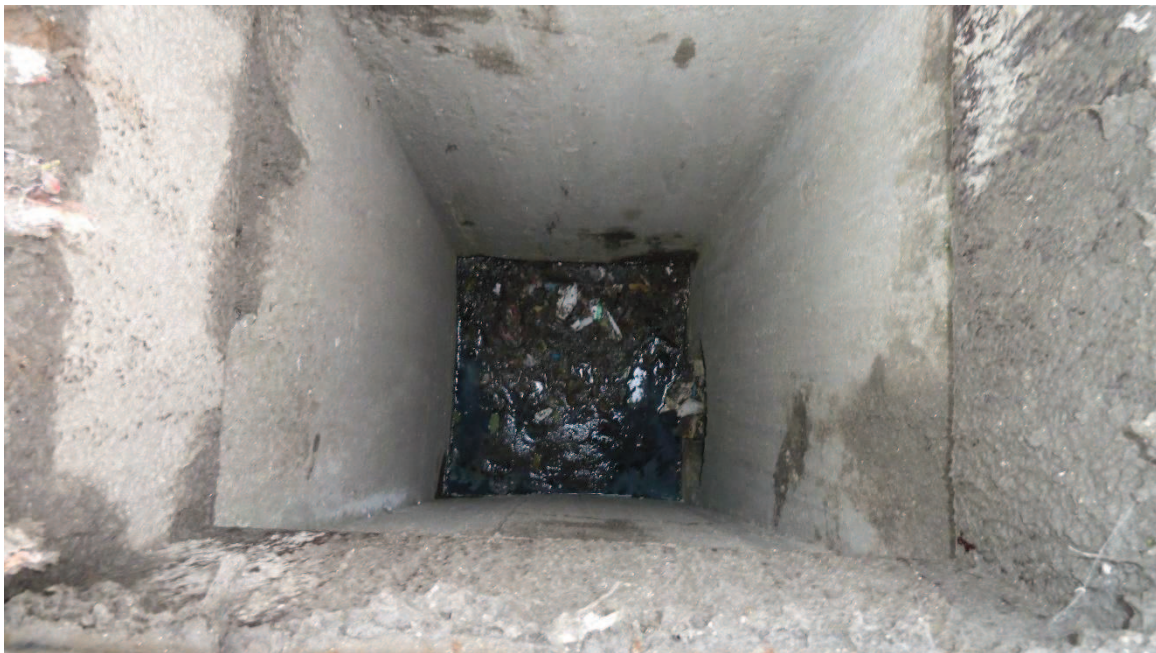
Figure 26. Avaloir A10 bassin versant E , à nettoyer
