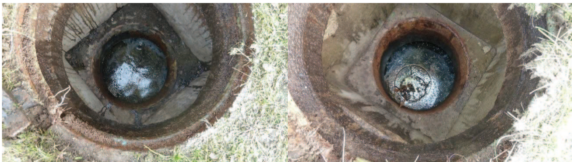
Figure 16. Séparateur d'hydrocarbure S2 aire de lavage
