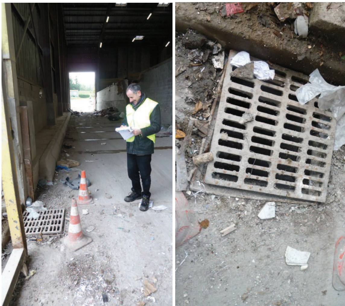
Figure 24. Avaloir A7 bassin versant F - A réparer et nettoyer
