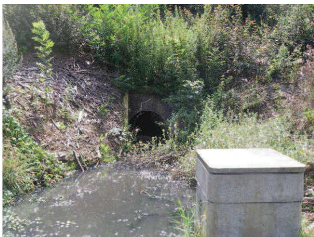
Photo 5-6 : Débordement par temps sec du regard situé en amont du rejet au Ru sur le site du local DDD
