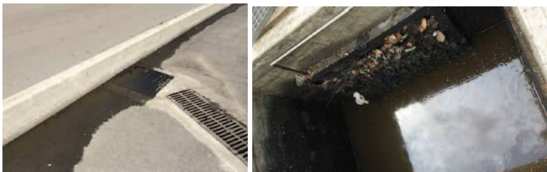
Photo 5-5 : Débordement de l'avaloir A6 et encrassement du dégrilleur en amont du bassin
