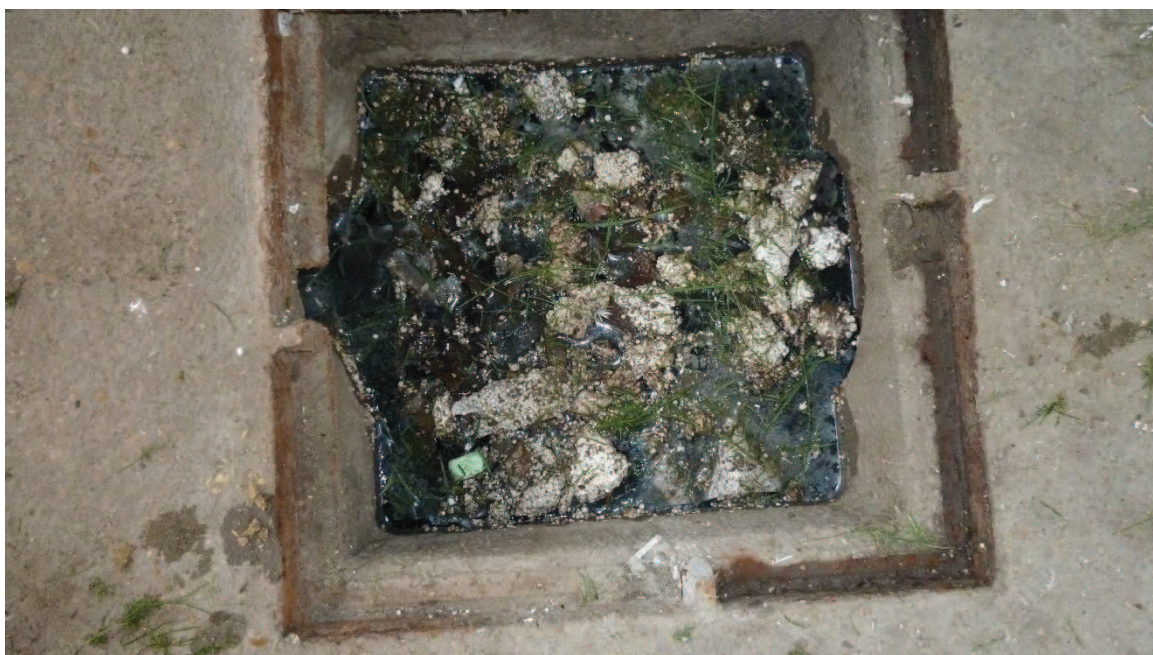
Figure 28. Avaloir A8 bassin versant D A nettoyer
