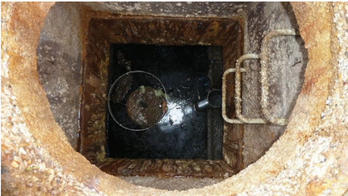
Figure 32. Débourbeur déshuileur S1.
