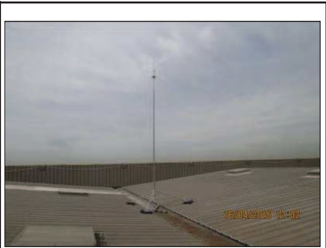
1.2 Photo du paratonnerre concerné
