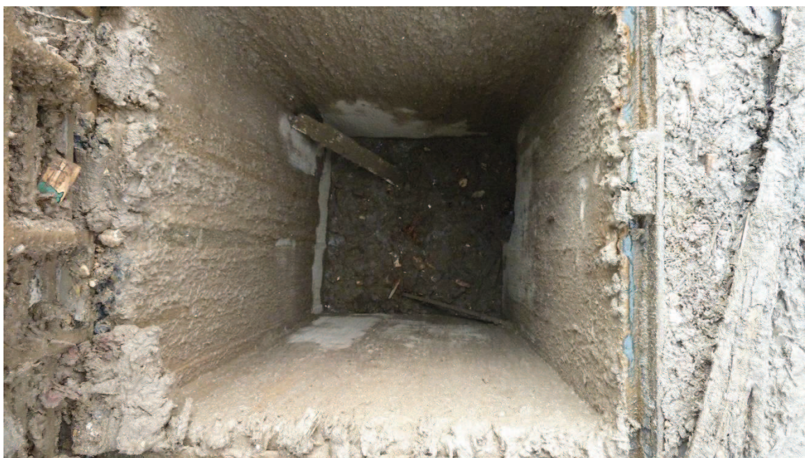
Figure 17. Avaloir A3 bassin versant C - A nettoyer
