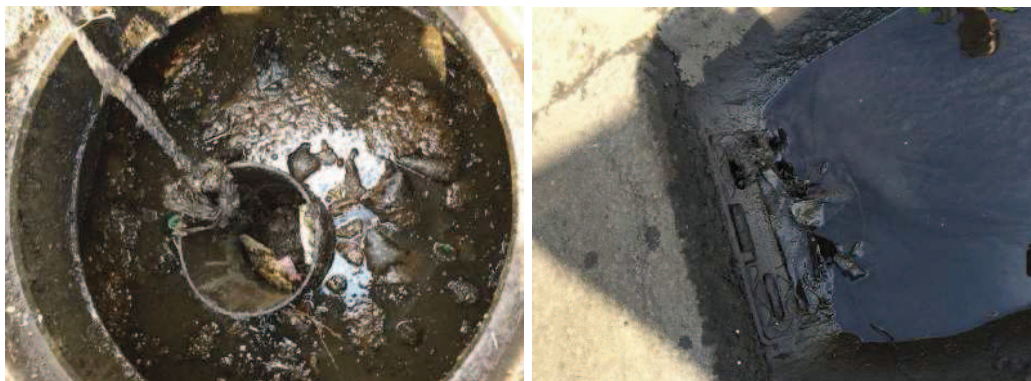
Photo 5-4 : Séparateur S2 et avaloir de l'aire de lavage semi-automatique (août 2014)
