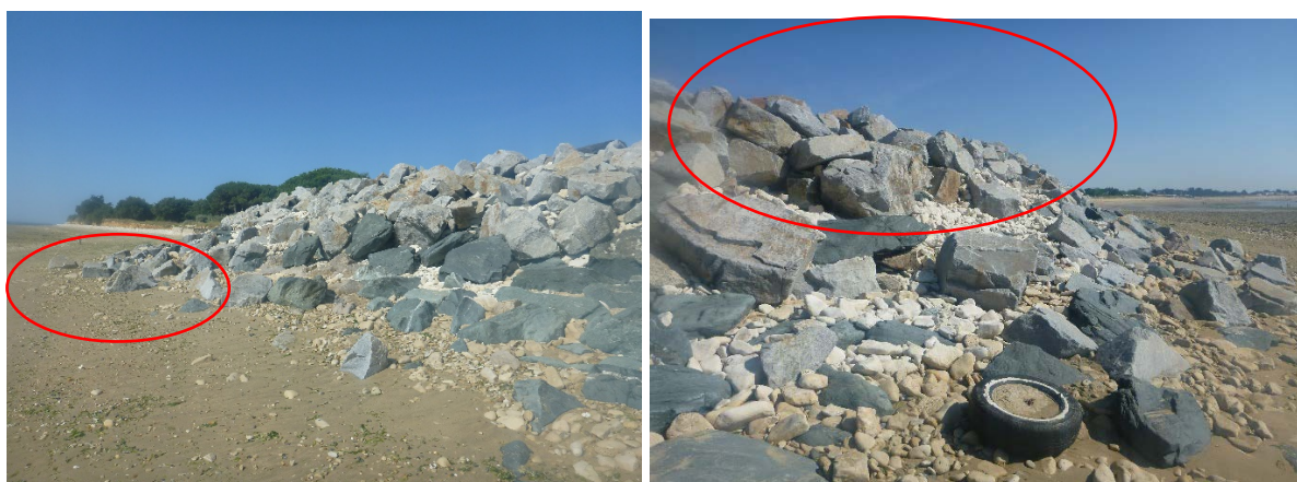
Figure 12 : Enrochements en dehors de l'emprise de l'ouvrage (g) et pente très abrupte en tête (d).
