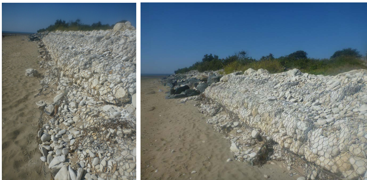
Figure 11 : Gabions désagrégés en pied et déformés en tête
