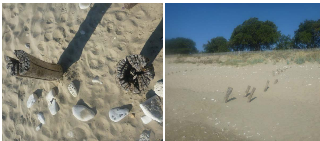
Figure 17 : Pieux fendus sur toute ou partie de leur hauteur apparente (h) et (g) et pieux inclinés (d).
