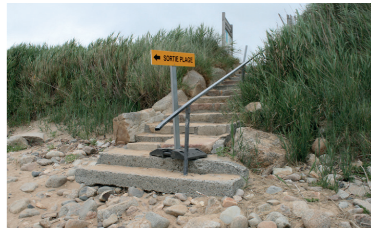
Une descente de plage en pierre et en béton, endommagée et peu qualitative.
