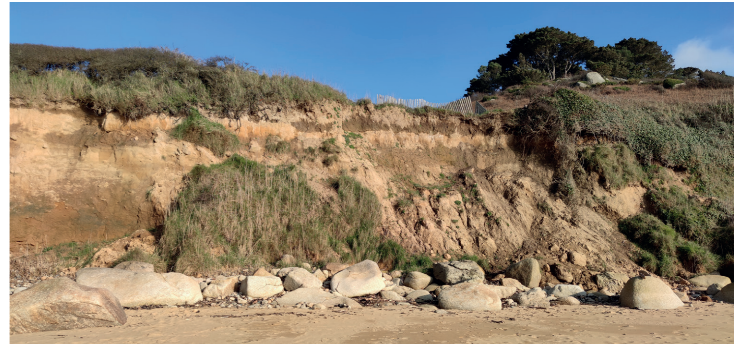
La falaise meuble s'effrite, menaçant les infrastructures.
