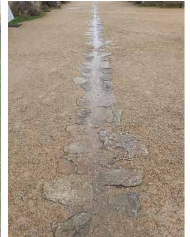
Rigole de gestion de eaux pluviales
