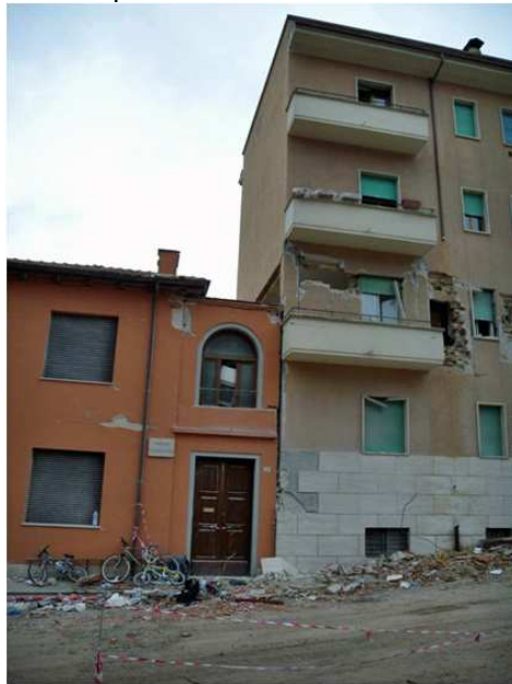
Exemple de martèlement. Séisme de L'Aquila 2009
